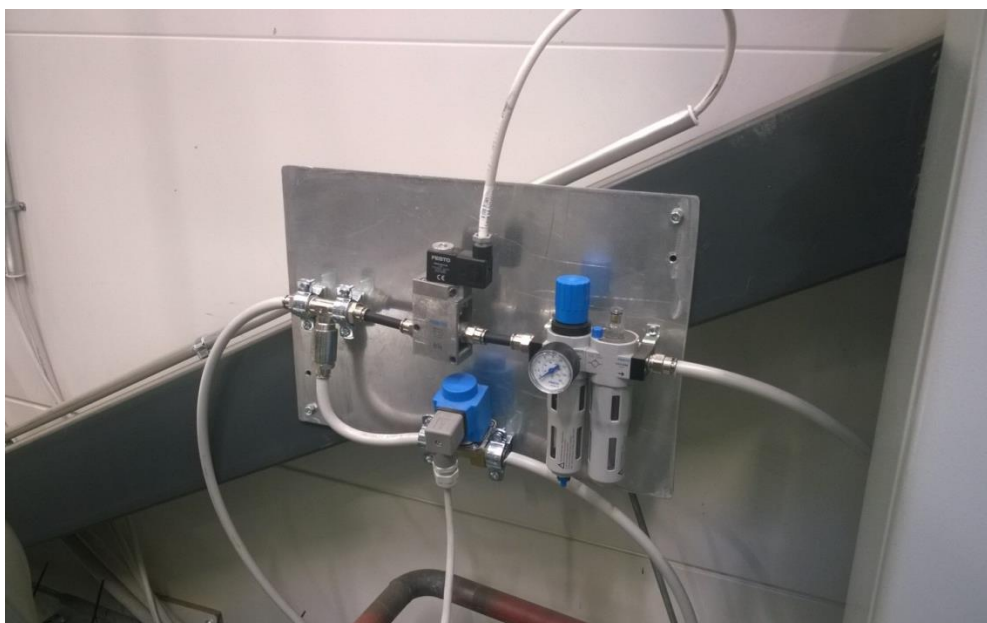
KUVA 5. Lankaravistimen magneettiventtiili oheislaitteineen
