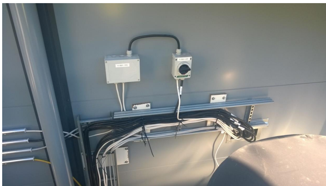
KUVA 3. Eristinlämmittimen turvakytkin ja riviliitinkotelo
