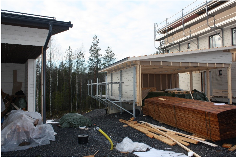
Etäisyys naapurirakennukseen alle 8 m (Kuva: Mikko Mella-Aho 2017.) (ks. Liite 6).
