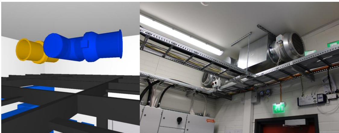
Kuva 2. Ilmanvaihtokanavan päätte-elin yhdistelmämallissa ja valokuva toteutuneesta asennuksesta
