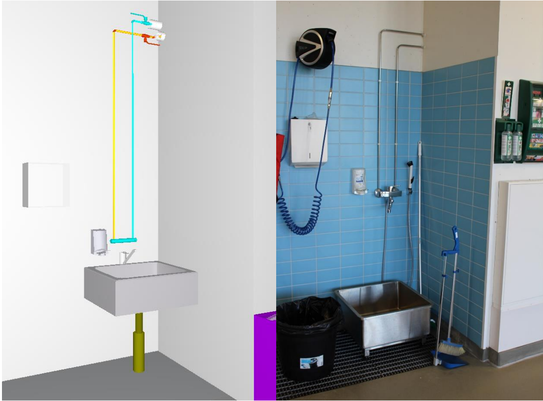
Kuva 12. Autohallin vesipiste varusteluineen
