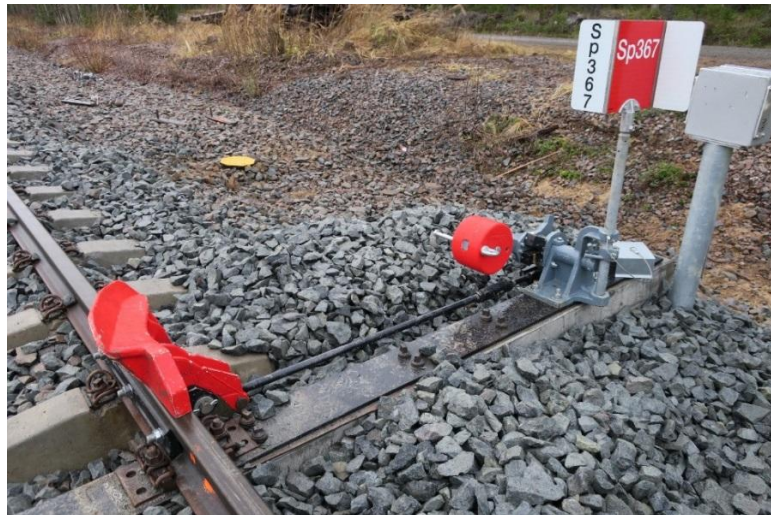
Kuva 2. Avainsalpalaitetekotelo oikealla ja varmistuslukolla varmistetun raiteensulun käsikäntölaite.
