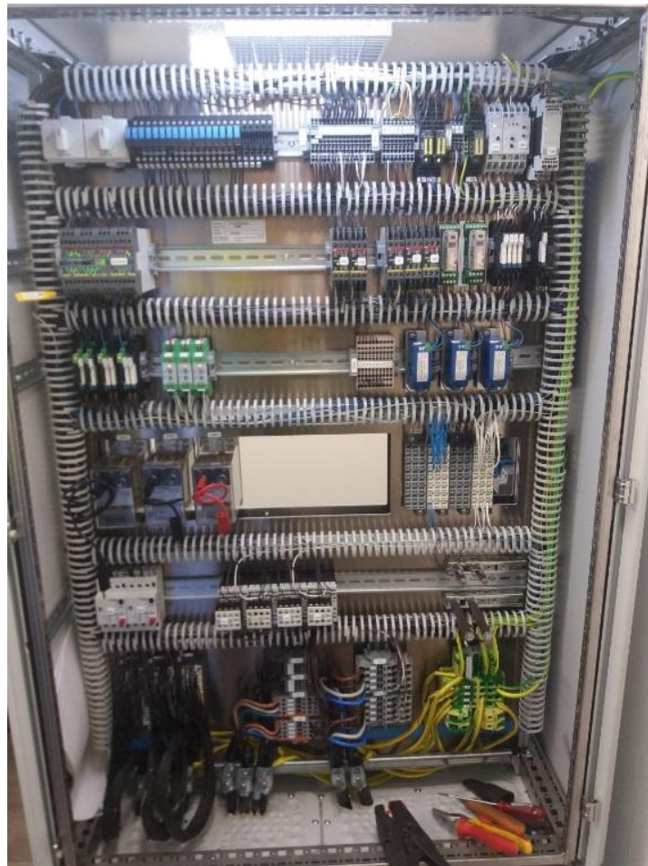
Kuva 9. Varoituskäytön kytkentäkaappi logiikoinen
