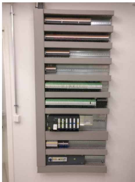
Kuva 3. Kauko-ohjauksen rajapintateline Tikkaperän laitetilalla.
