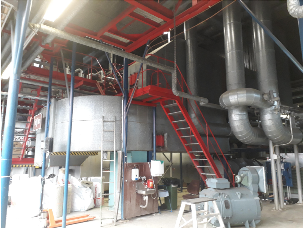
Kuva 4. A-puolen kattilahallin alataso.
