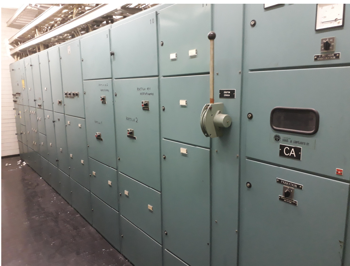
Kuva 6. Pääkeskus CA sekä keskuksset CB ja CC.
