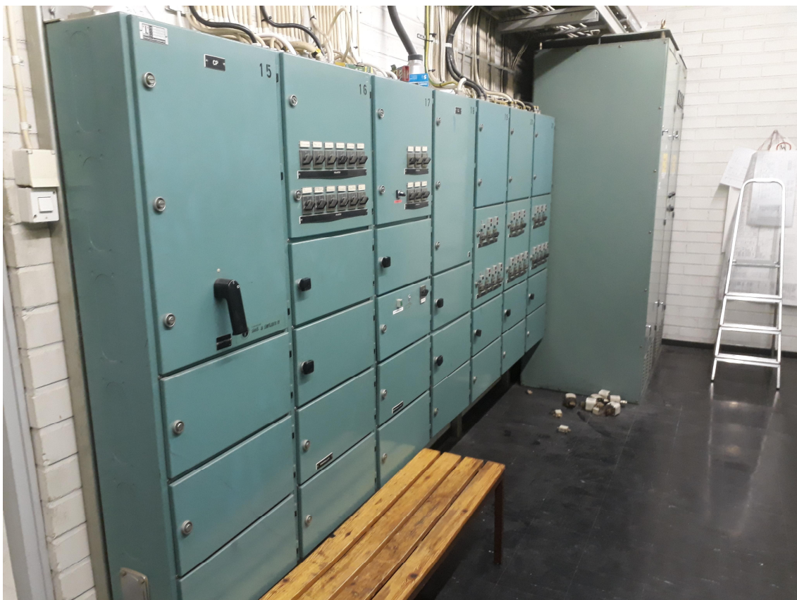
Kuva 7. Valaistuskeskus CP ja ilmastointikeskus CL.
