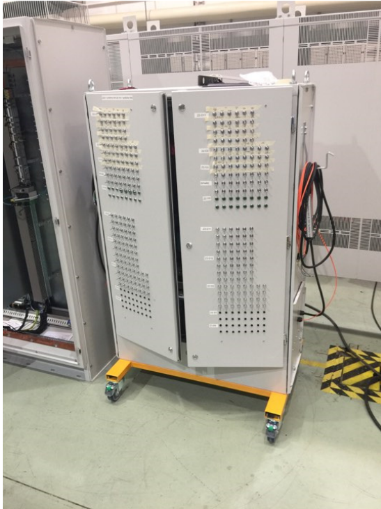
Kuva 10. Testilaitteen oikeassa kyljessä roikkuvat sähkökaapeli ja valokuitukaapeli. Ovessa kytkimet ja merkkivalot. Laitteen alla pyörillä liikkuva teline.
