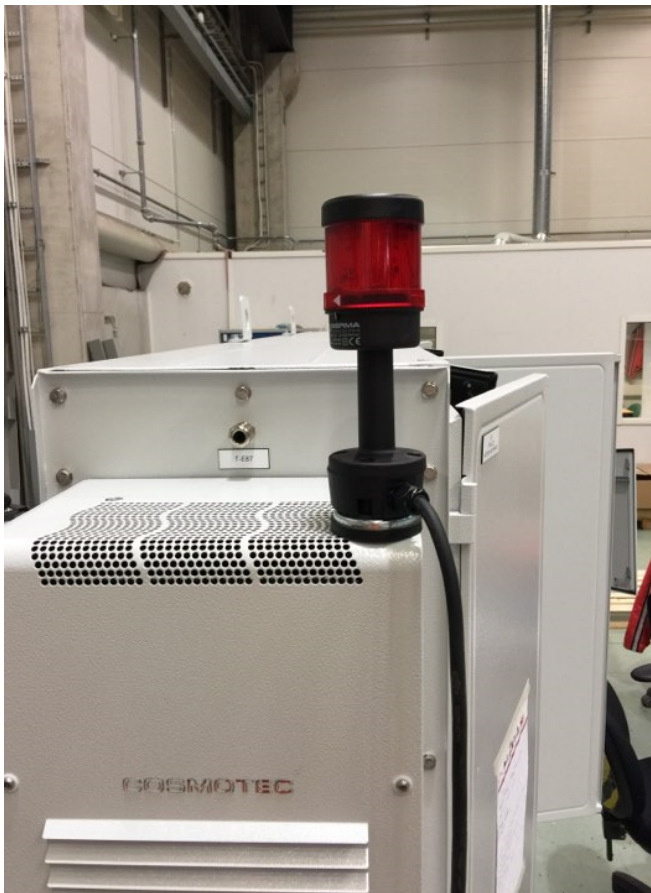
Kuva 12. Punainen merkkivalo sähkökeskuksen päällä.
