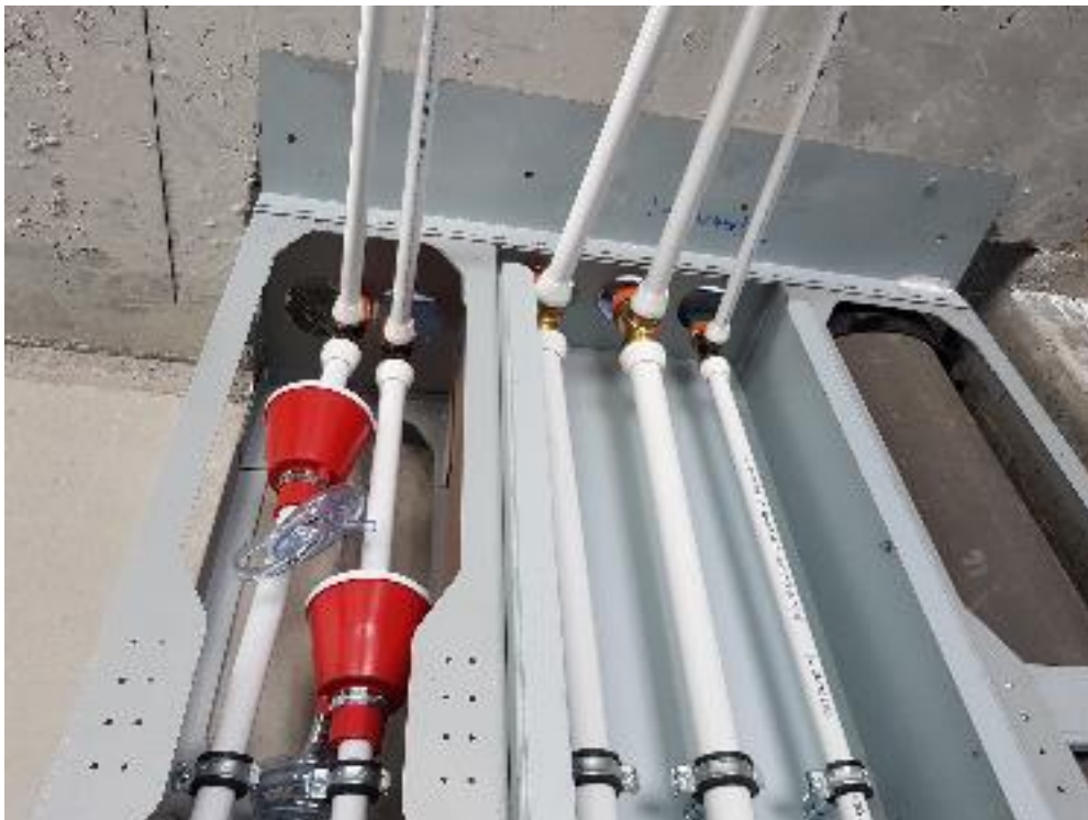
Kuva 4. Cefo-elementtien vuodonilmaisimet lämpöjohdoissa
