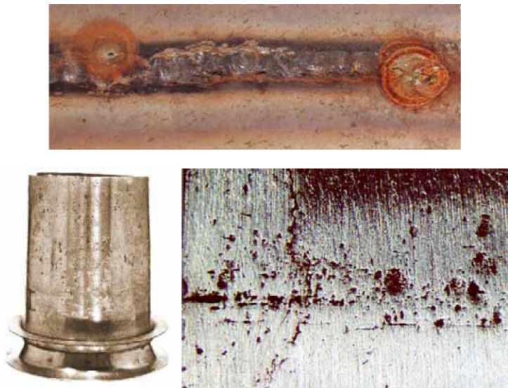
Kuva 6. Yläkuvassa ruostumattoman teräksen hitsissä olevia paikallisia pistesyöpymiä (lähde: VTT). Alakuvissa laajempialaista pistekorrosiota (lähde: http://www.outokumpu.com ).
