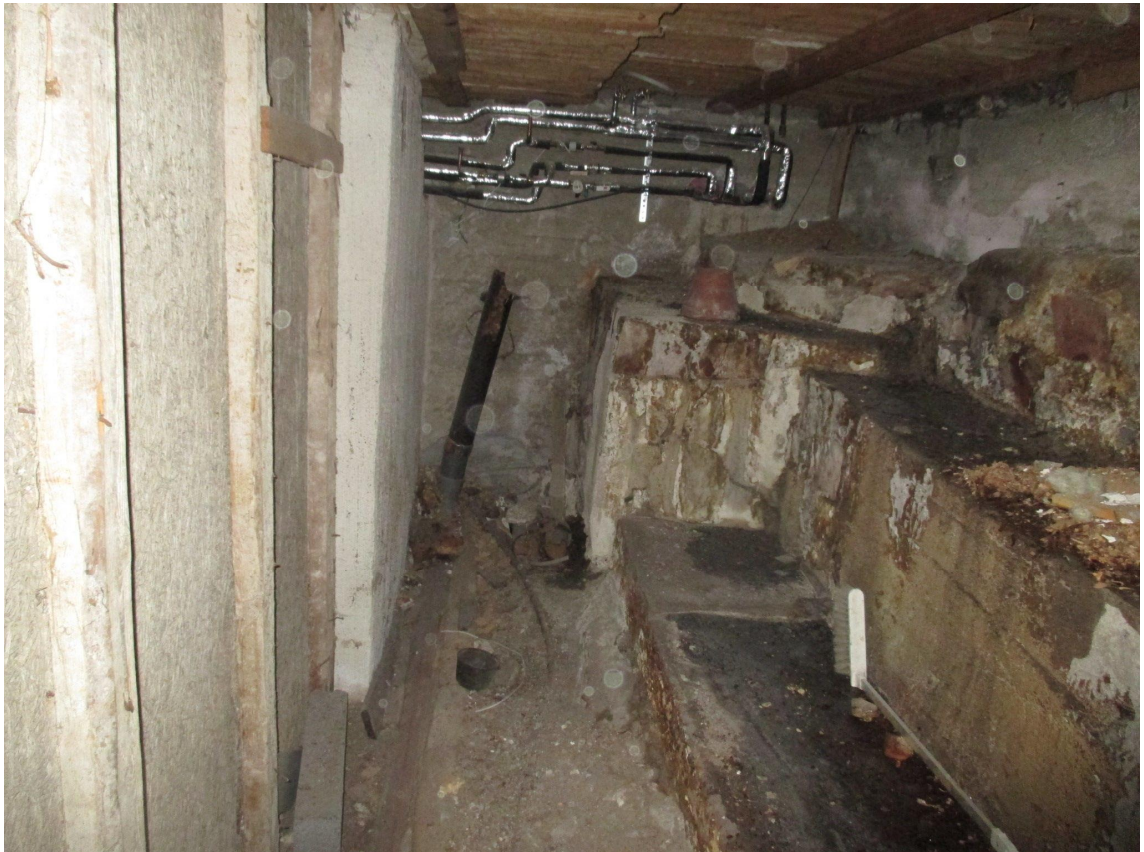
Kuva 7. Kallionpinta näkyvissä kellaritiloissa. Kosteuden aiheuttamia jälkiä betonissa ja kalliopinnalla.
