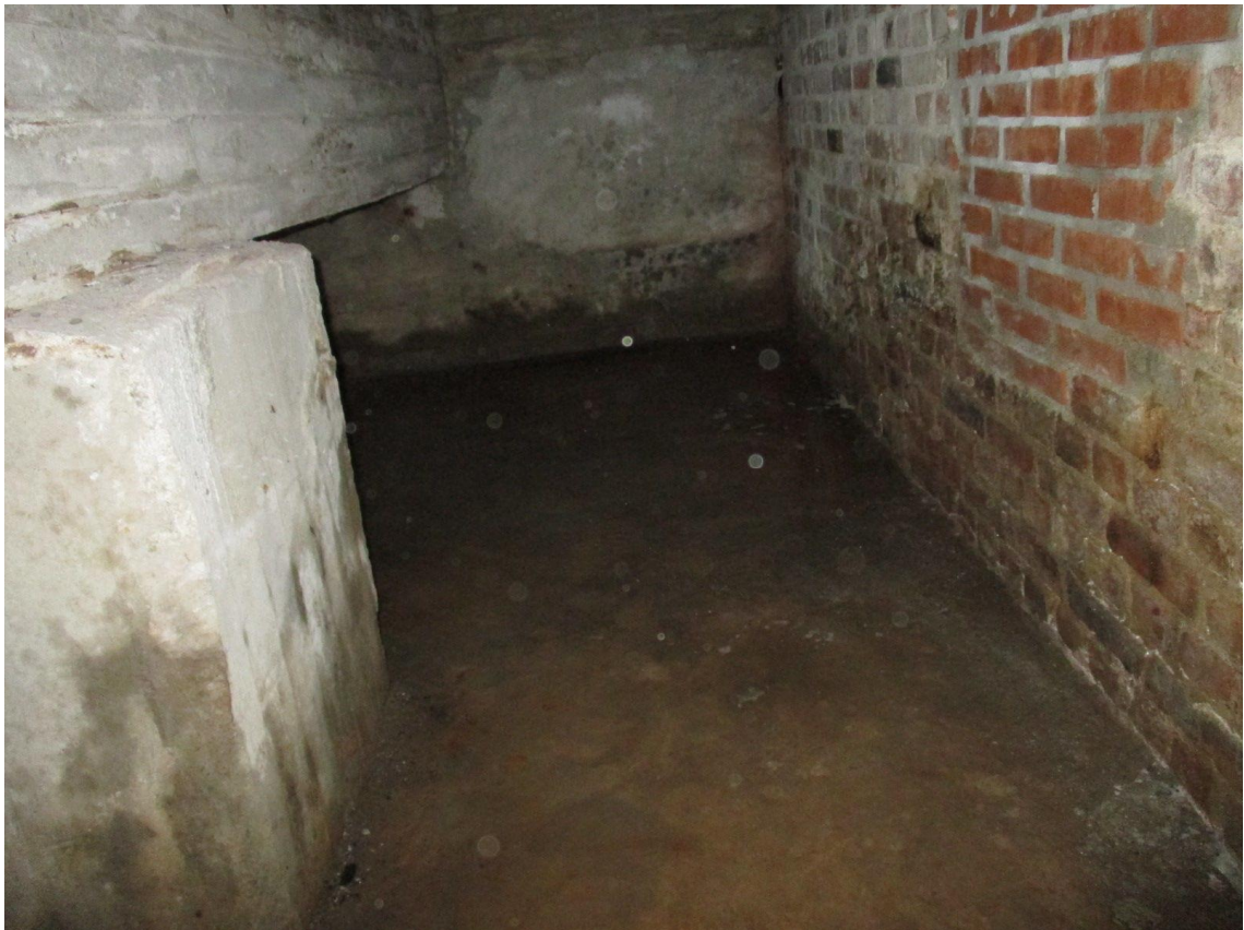
Kuva 29. Vettä ryömintätilassa portaiden alla sekä kastuneita rakenteita
