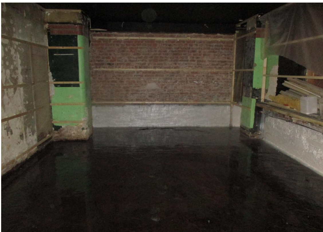
Kuva 15. Maanvastainen alapohja pinnoitettu diffuusioavoimella pinnoitteella.
