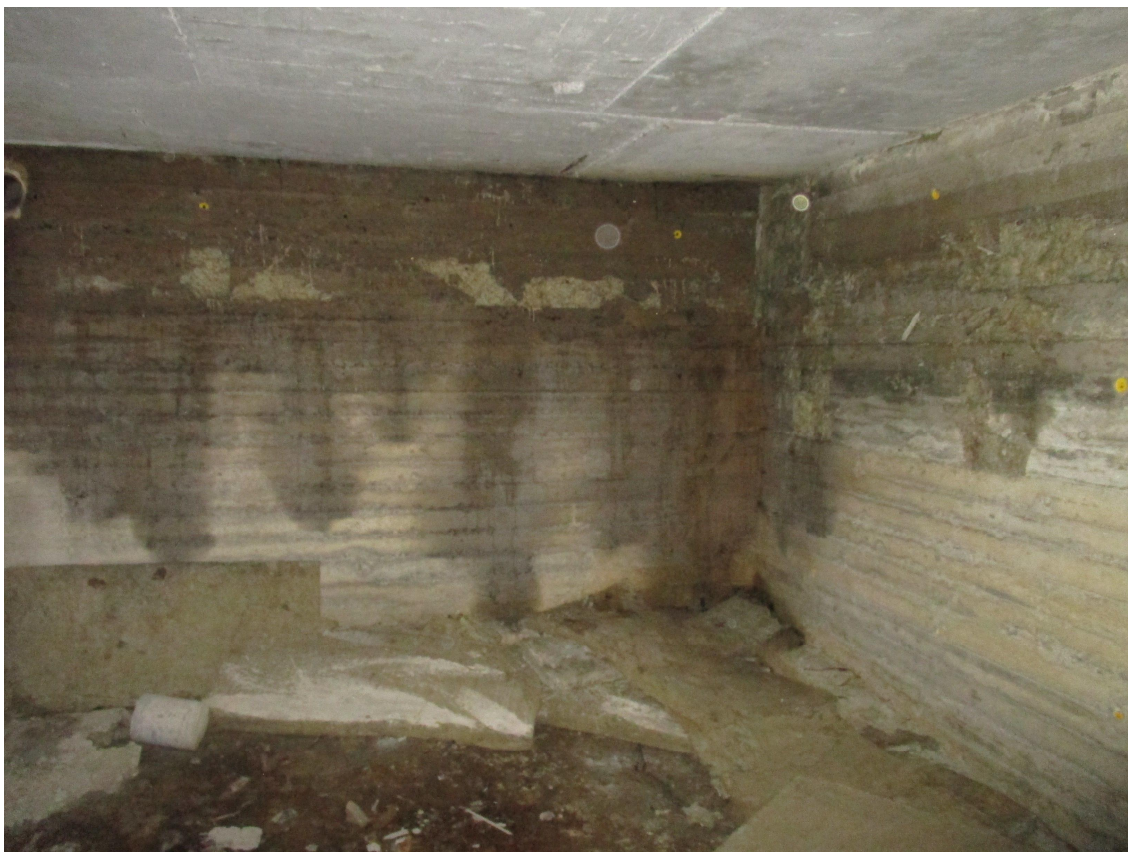
Kuva 16. Kellarin seinässä kosteusjälkiä ja alustastaan irronneita lämmöneristeitä.
