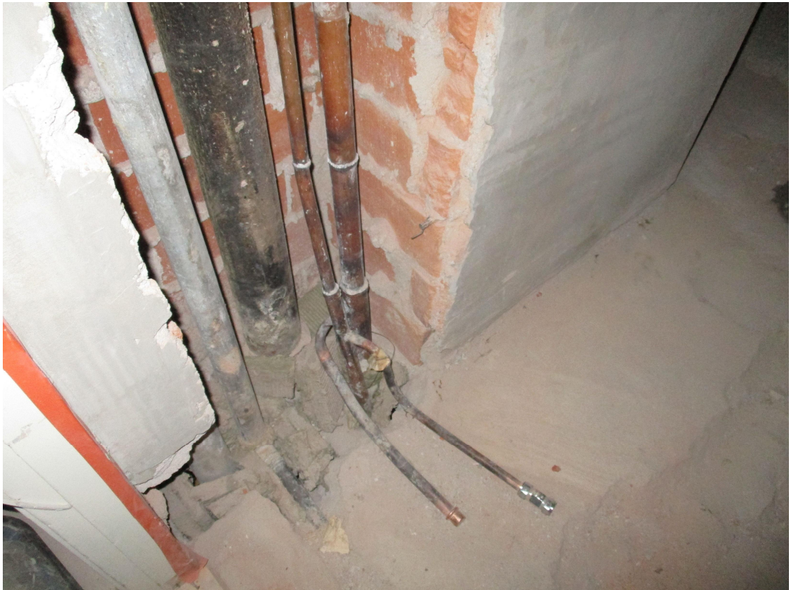
Kuva 9. Vanhat viemäriputket ja vesijohdot nousuhormissa.
