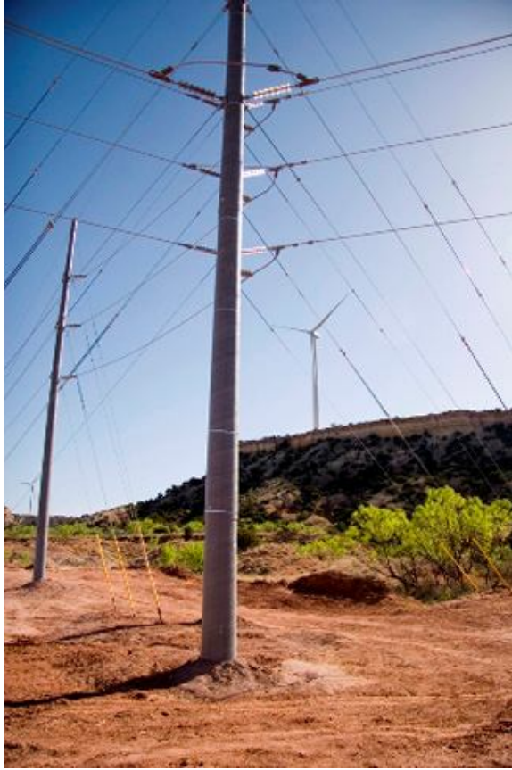
Kuva 5. Komposiitista valmistettu sähköpylväs Englannissa
