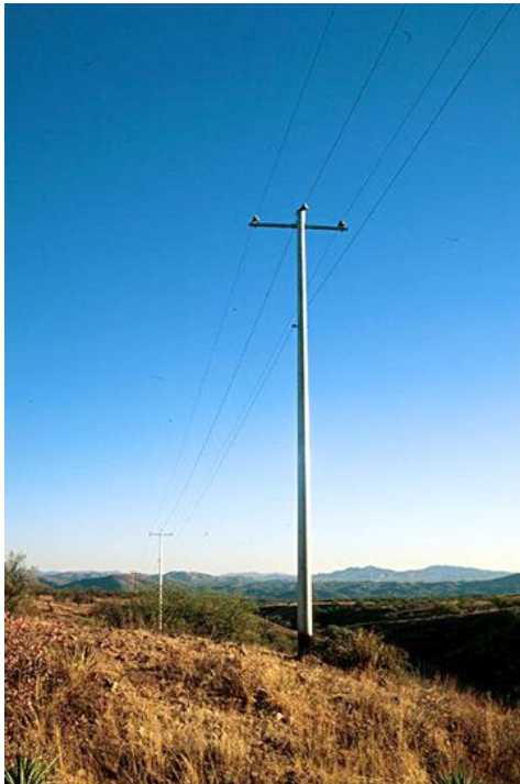
Kuva 3. Teräksestä valmistettu sähköpylväs.
