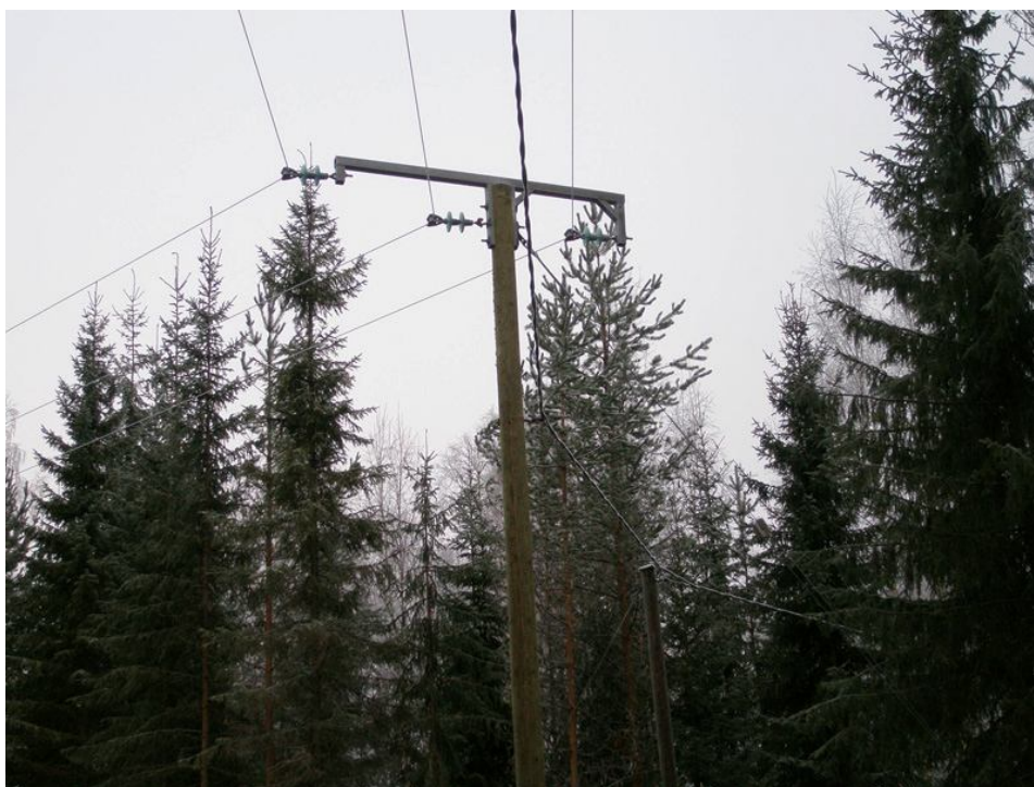
Kuva 2. 20 kV+0,4 kV. Tasokulmaorsi. Latvan päälle asennettava malli. Vuodelta 2009. Pieksämäki, Ihalaiskylä 3.12.09 Kuvaaja: Petri Mäki
