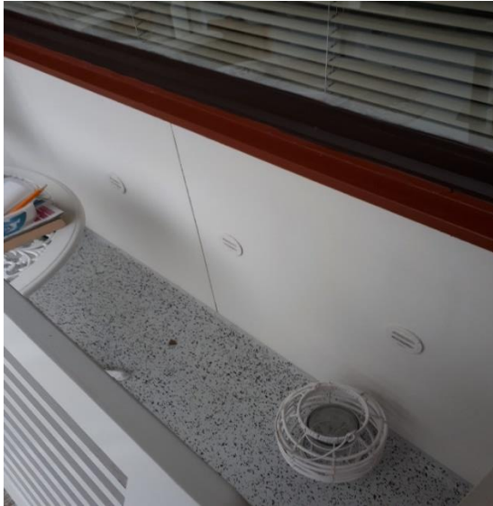
Kuvio 15. Olohuoneen korvausilmaventtiilit ulkoa parvekkeelta kuvattuna.
