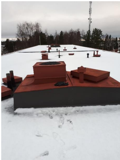
Kuvio 12. Poistoilmapuhallin rakennuksen katolla.
