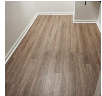
Kuva 26. Tila, jossa on käytetty Pergon vinyylilankkua.
