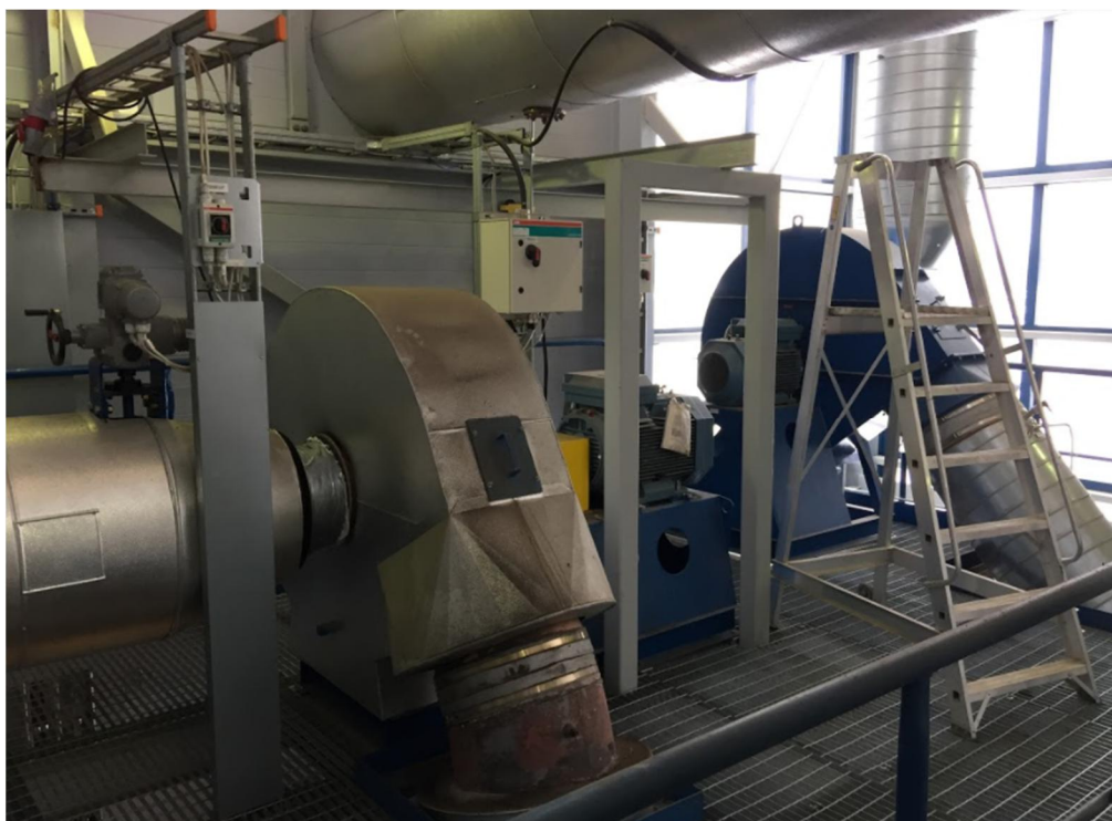
Kuva 17. Kiertokaasu- ja palamisilmapuhaltimet.
