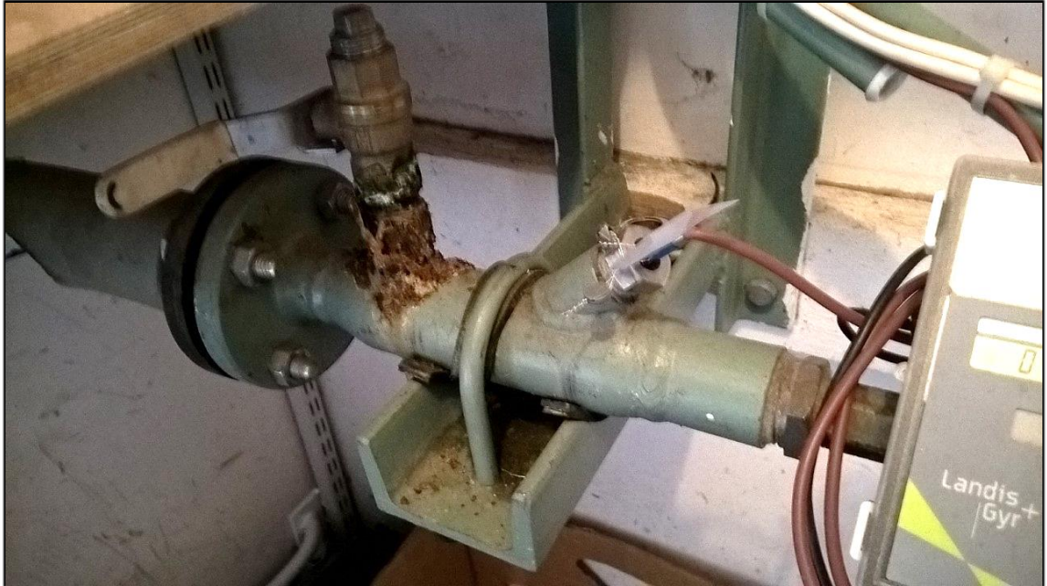
KUVA 12. Korroosion syövyttämä ilmanpoistoverttiili
