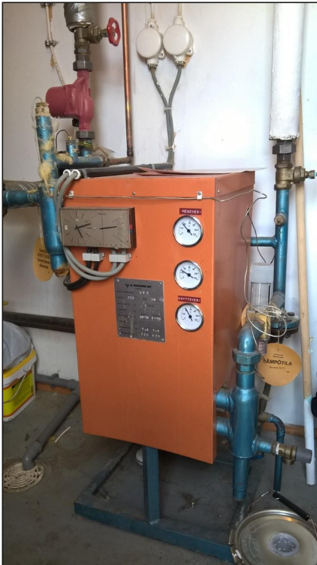
KUVA 7. Kotimainen Viikari lämmönjakokeskus vuosimallia 1979
