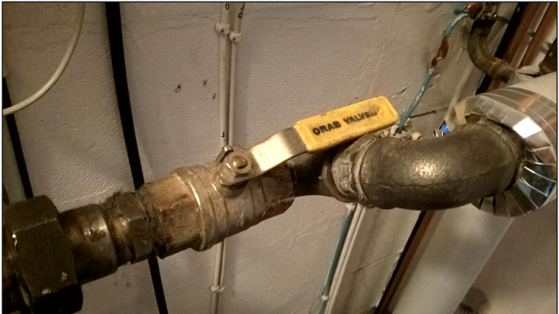
KUVA 10. Käytön estävä virheellinen sulkuventtiilin asennus
