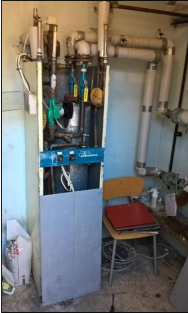
KUVA 8. Galvanoimis Oy:n valmistama lämmönjakokeskus vuosimallia 1979
