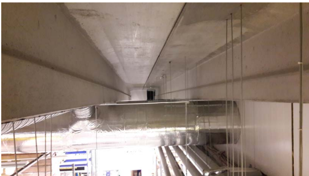
Kuva 33. TEK-laatat, joissa on havaittavissa jännevoiman aiheuttamaa alkukäyritystä.
