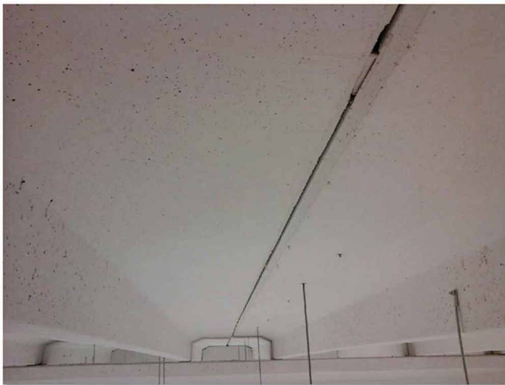
Kuva 34. Elementin pinnassa on ”koloja” huonosta tiivistyksestä johtuen.
