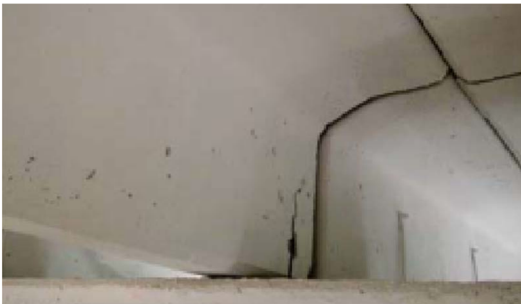
Kuva 36. Jännepunoksen liukuman aiheuttama halkeama TT-laatan rivan päässä.
