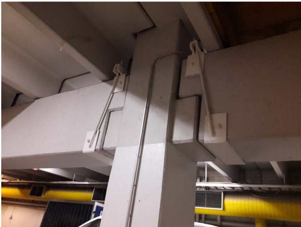
Kuva 27. Leikkausvoimien siirtäminen tuelle teräsosalla. Kuvan palkissa on leikkaushalkeamia.
