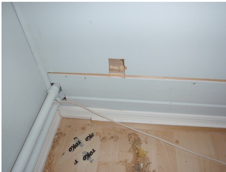
Kuva 3: Näytteenottoaikan 2 reiät paikattu tilapäisesti teipillä, seinällä näytteenottoaikka 4.
