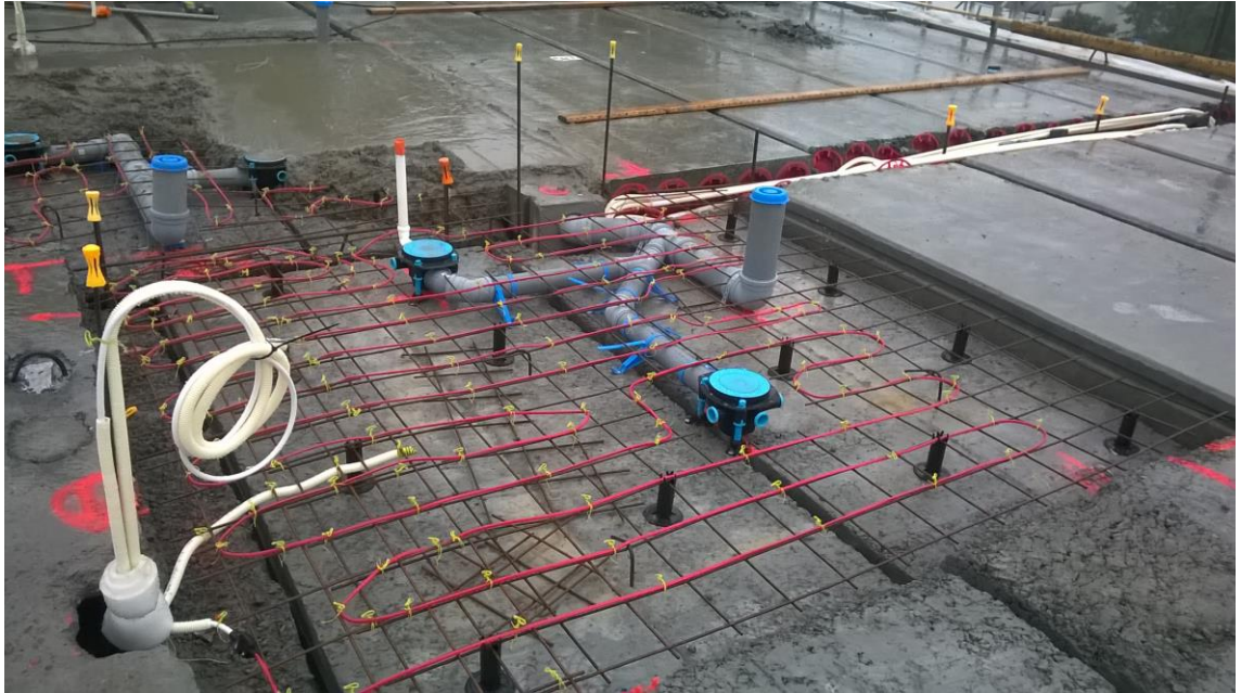
Kuva 6. Kololaatan talotekniikkaa. Kuva Marianne Lindberg.
