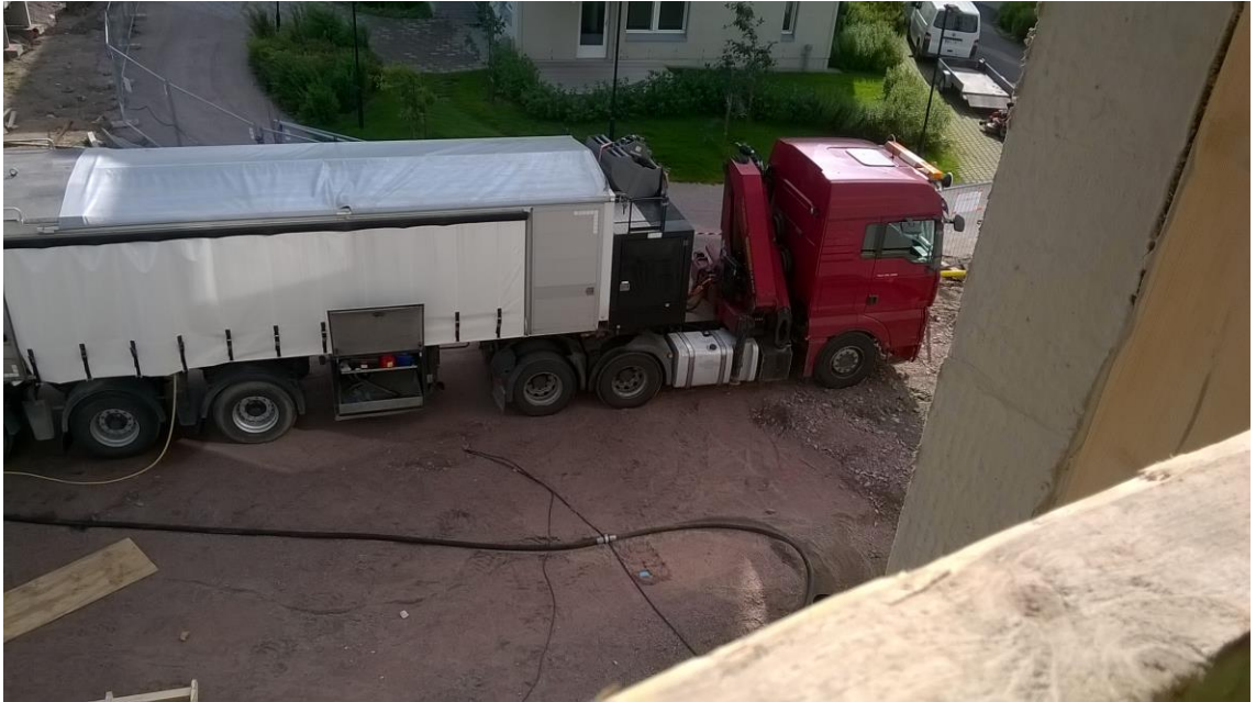
Kuva 8. Bekasonin betoniasemarekka. Kuva Marianne Lindberg.
