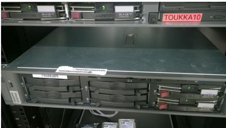
Kuva 4. Kuva tarramerkitystä laitteistosta, joka jää tuottajan ICT-laitetilaan
