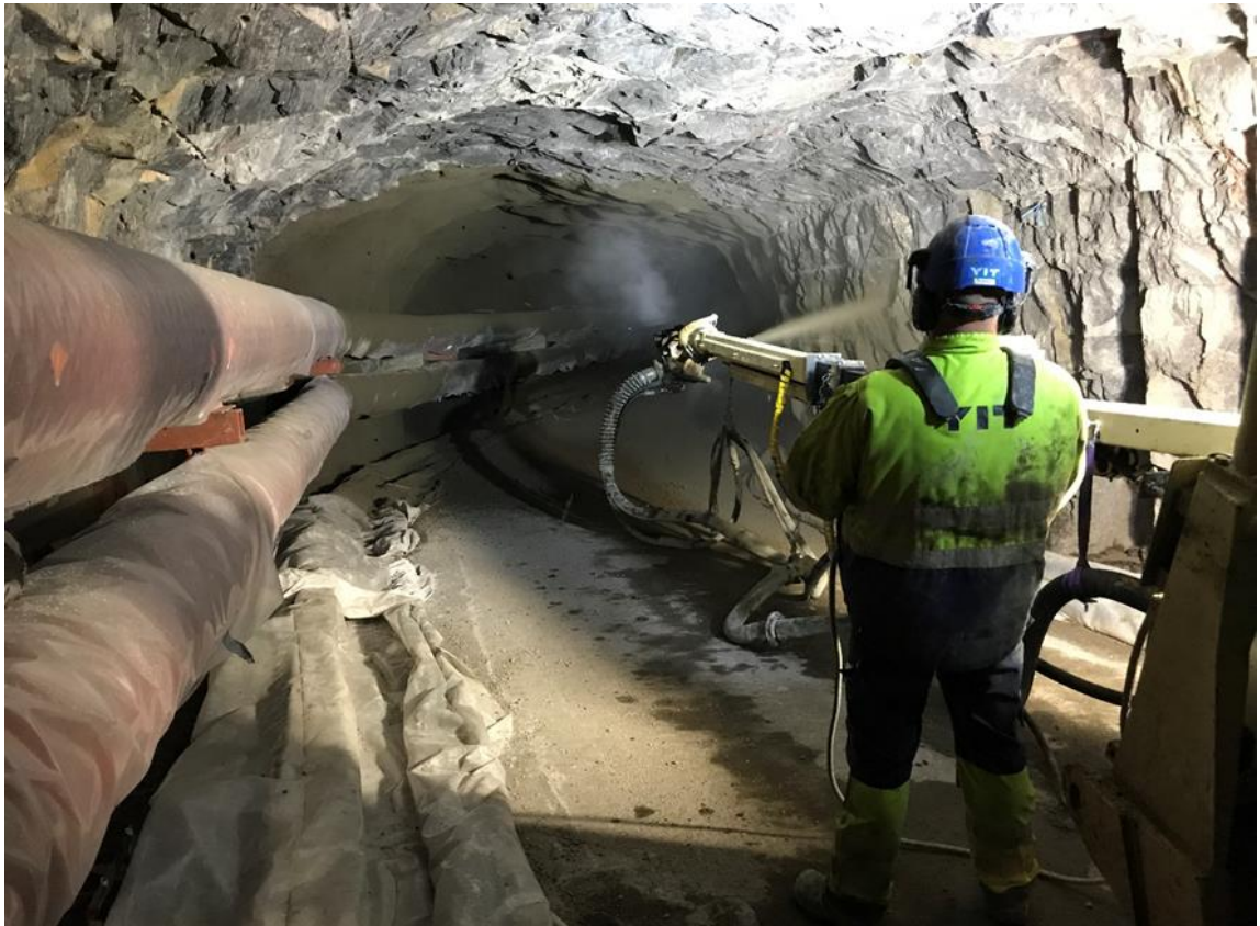
Kuva 8. Ruiskubetonointia Suomenlinnan huoltotunnelissa. Seinällä kaksi kaukolämpöputkea ja alhaalla vesi- ja viemäputket, sekä jännitteetön 10kV kaapeli omassa suojakourussa. [Rinkinen, 2017, YIT]
