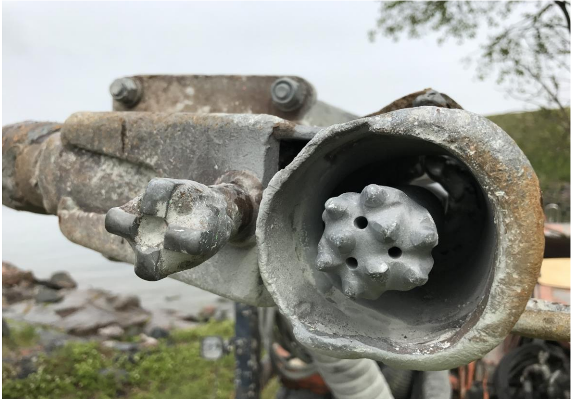
Kuva 2. Vasemmalla kalliotuki ja oikealla porakruunu. Porakruunun on oltava koko ajan kalli- ossa kiinni. [Rinkinen, 2017, YIT]
