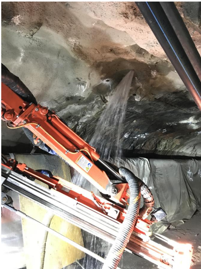
Kuva 19. Paikka paikoin jälki-injektointireikiä poratessa vesi suihkusi rei'istä valtavalla paineella. [Rinkinen 2017, YIT]
