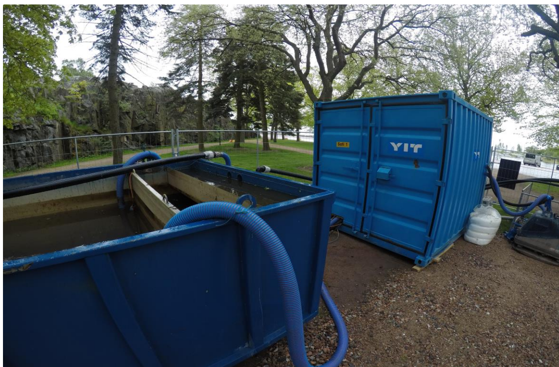
Kuva 17. Poistovesilinjan maanpäällinen osa. [Rinkinen 2017, YIT]
