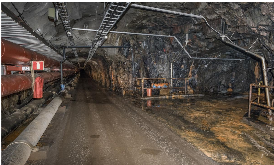
Kuva 12. Tunneli ennen peruskorjaamista. Oikealla näkyy, kuinka tunneli vuoti vettä ja sen mukana tulevia mineraaleja. [Suomenlinnan hoitokunnan kuva-arkisto/Arttu Kokkonen, 2015]
