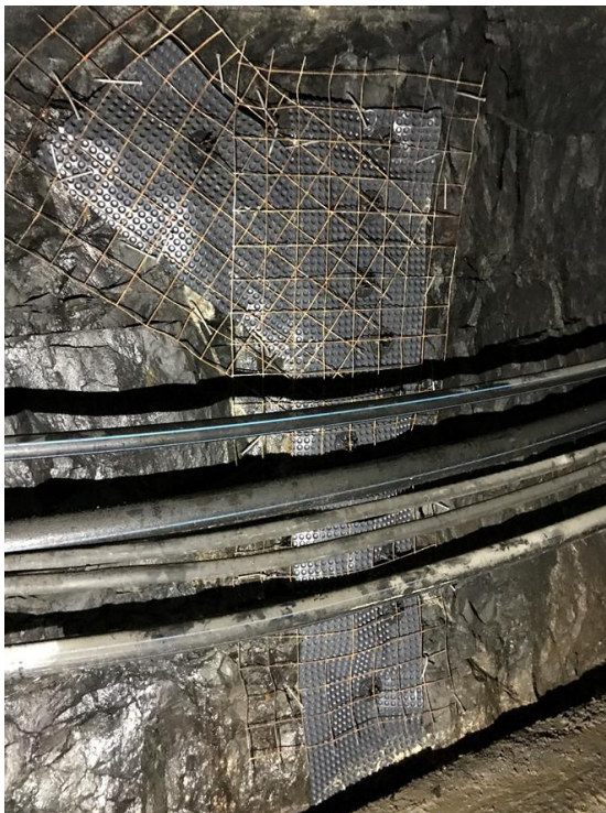
Kuva 16. Työn aikaiset varustelut Kaivopuiston päässä. Ylhäältä alas lueteltuna: painevesilinja, poistovesilinja, työmaa-sähkökaapeli, työn aikaisen pumppauksen sähkökaapeli, sekä työn aikaisen pumppauksen varapoistolinja. [Rinkinen 2017, YIT]
