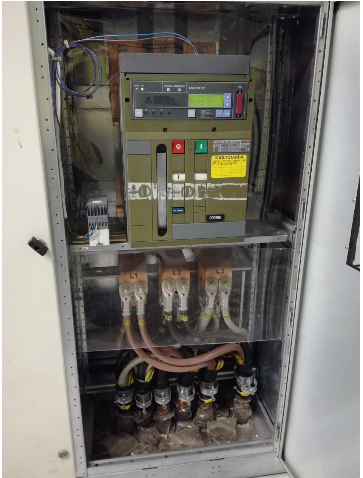
Kuvio 12. Katkaisijan kaapelointeja ja kosketussuojauksia, jotka voisivat olla keskuksen juureen asti.
