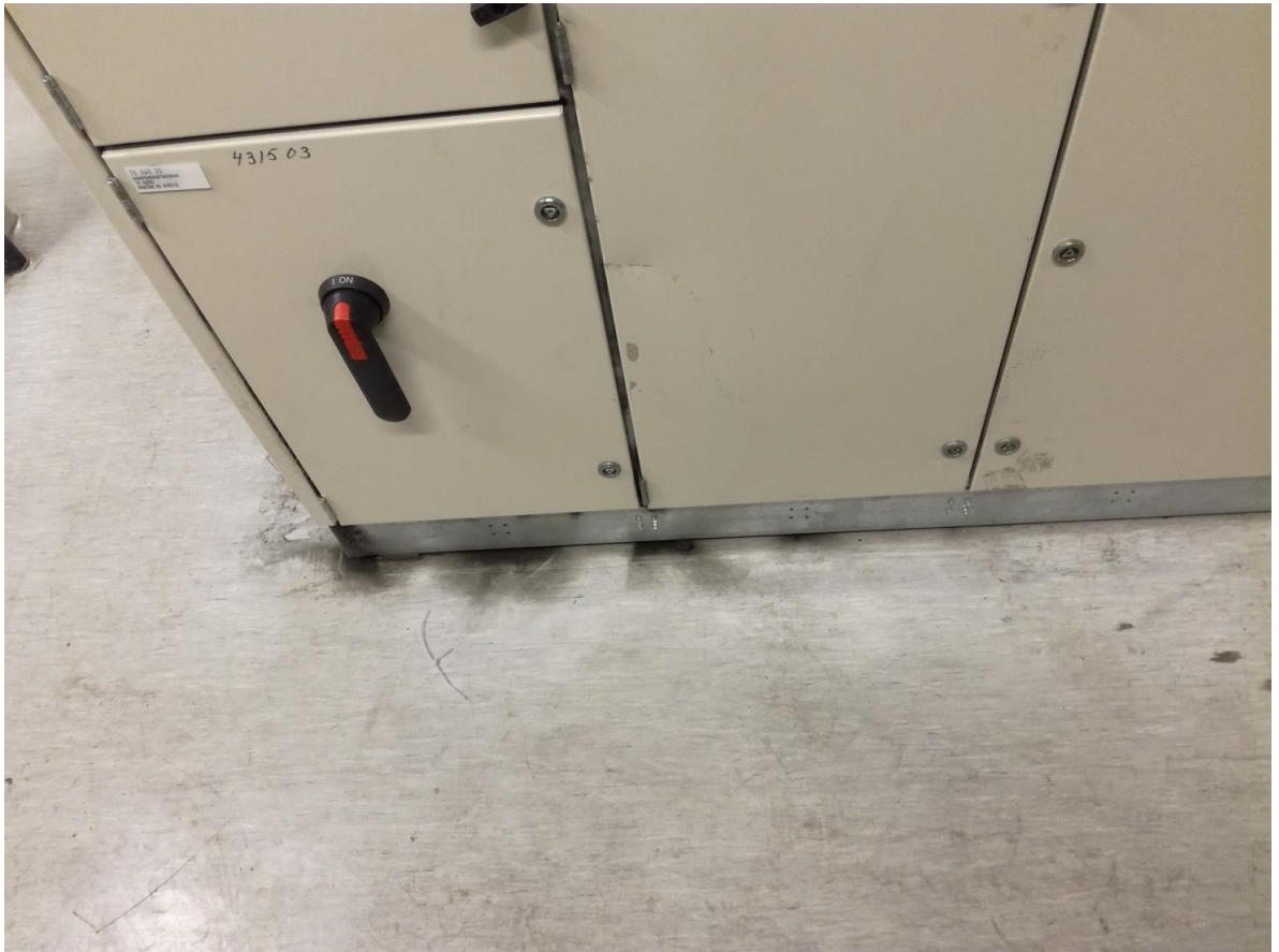
Kuvio 18. Kompensointikondensaattorin räjähdysten aiheuttamat mustumat. Nimikyltti on jäänyt paikoilleen, vaikka lähtöä ei enää ole. Myös dokumenteista unohtunut poistaa.
