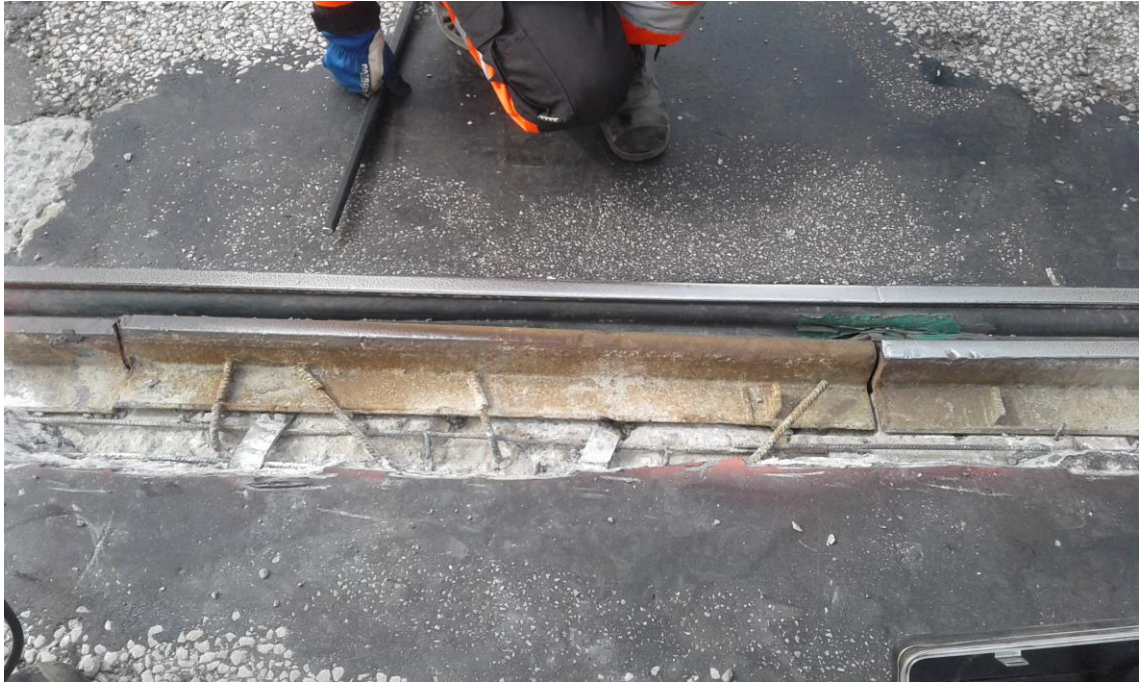
Kuva 8. Välitöntä korjausta vaatinut vaurio liikuntasaumalaitteessa. (Sami Katajamäki)
