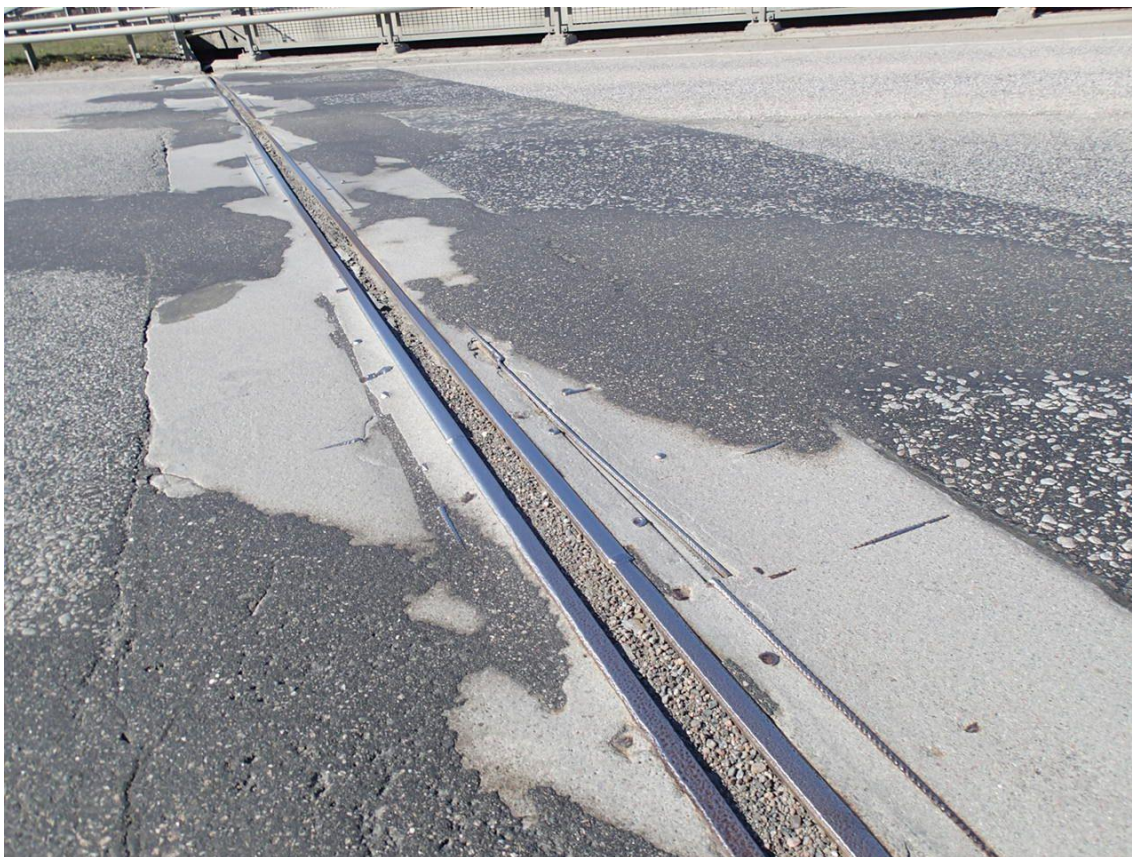
Kuva 10. Tukikaistan pinnassa olevia raudoituksia ja epäpuhtauksia liikuntasaumaprofiilissa. (Sami Katajamäki)
