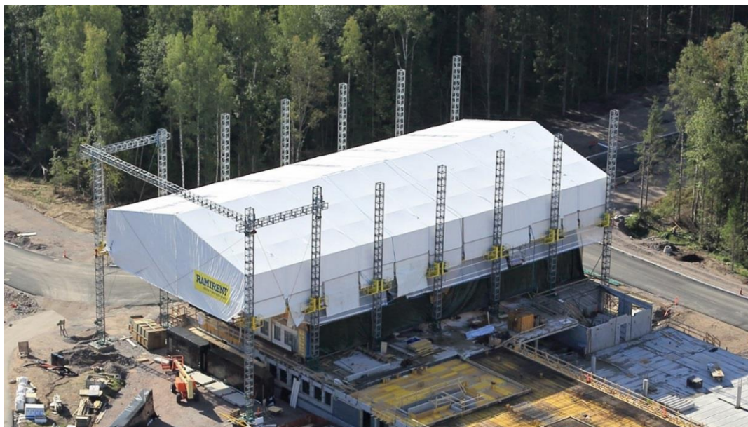
KUVA 16. Työn mukana nouseva rakennussuojakatto. (Ramirent.fi)
