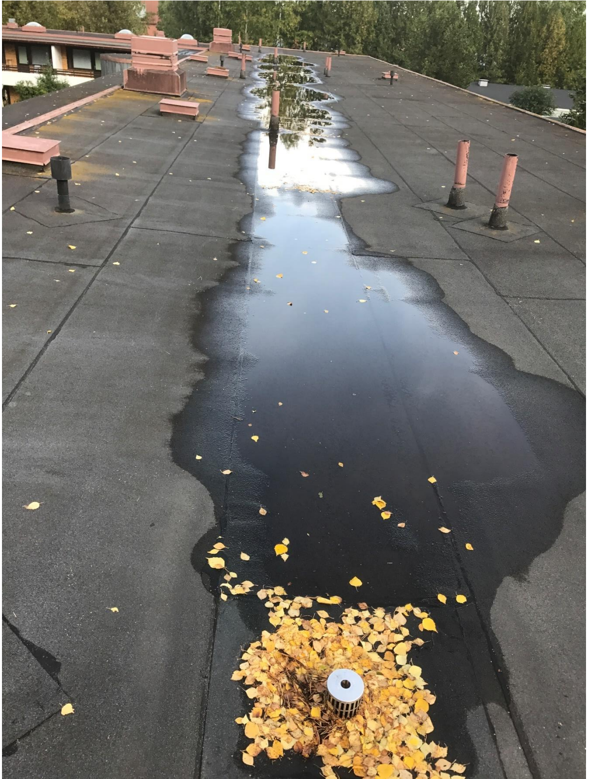
Kuva 4. Puutteellisen huollon ja muiden vaurioiden aiheuttama lammikoituminen. (Oja 2017).
