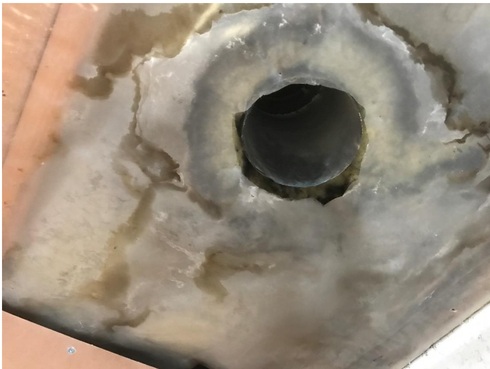
Kuva 2. Puutteellisen läpivientitiivistyksen aiheuttama kosteusvaurio (Oja 2017).
