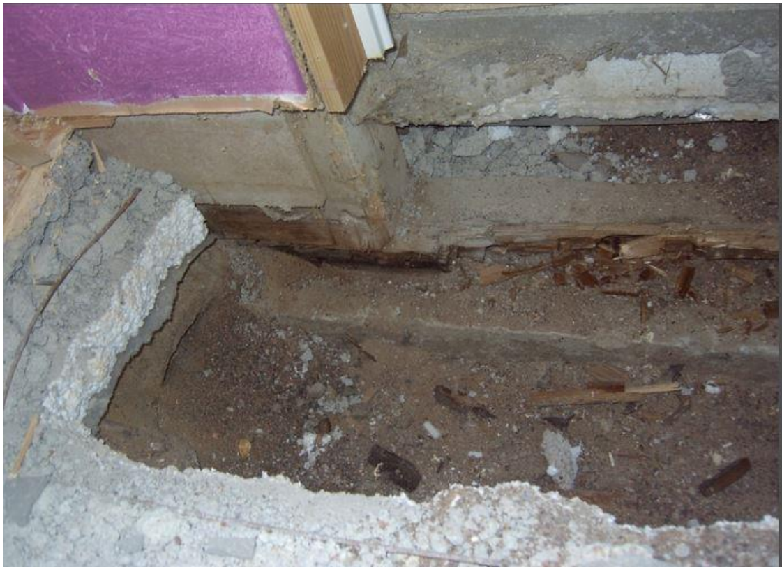
Kuva 1. Vaurioitunut ulkoseinärungon alaosa valesokkeli-rakenteessa (Ympäristöministeriö [Viitattu 15.4.2018]).
