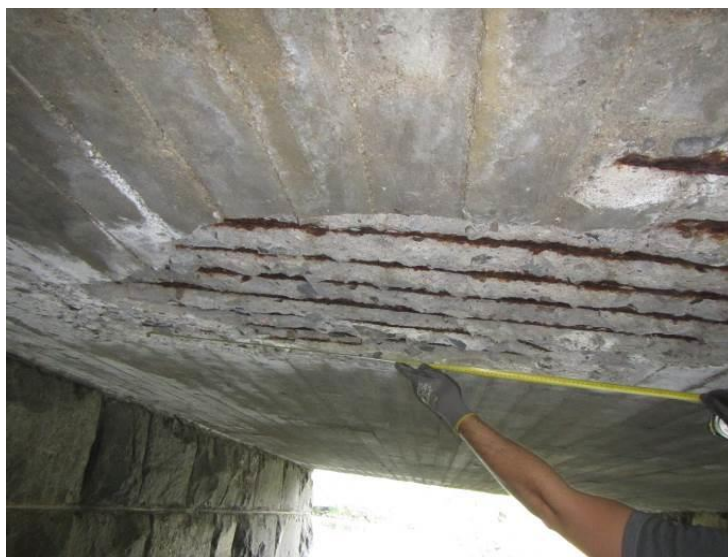
KUVA 3. Tiesillan pääteräkset ovat esillä ja ruosteessa (Erikoistarkastus, WSP/Immonen 2016)
