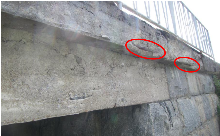
KUVA 5. Reunapalkki on pahoin vaurioitunut (Erikoistarkastus, WSP/Immonen 2016)
