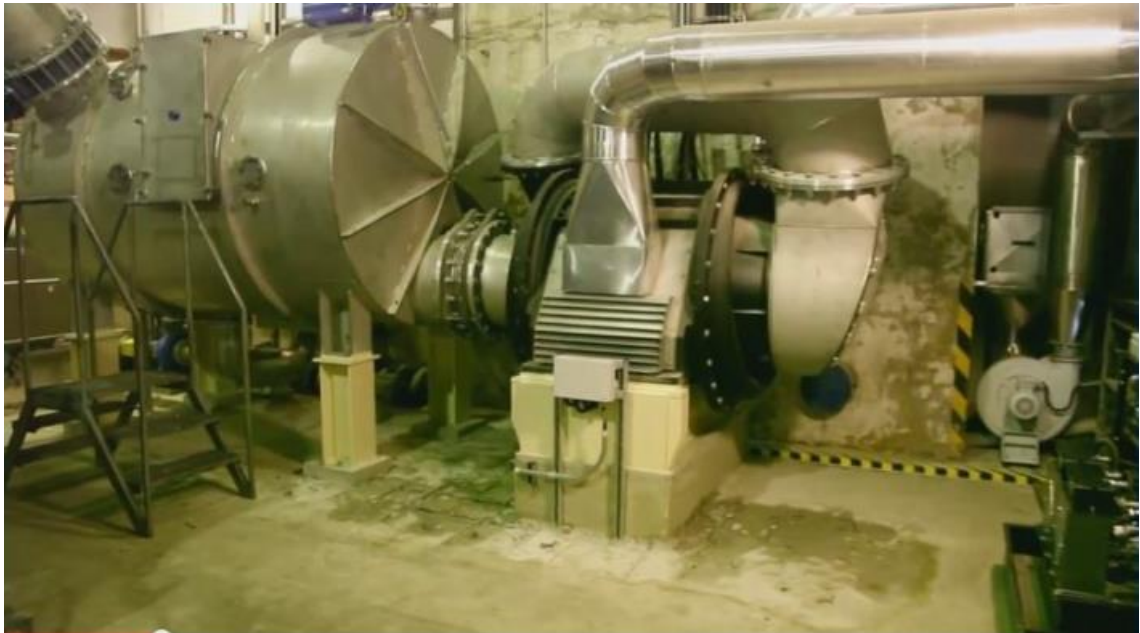
KUVA 1. Runtechin EP500-700-S -turbo ja tyhjöjärjestelmä tehtaalle asennettuna (Runtech 2015).
