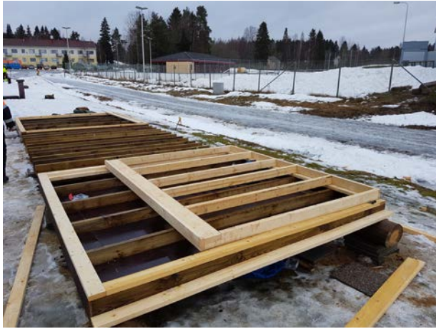
KUVA 3-2. Sisäasennuskoppien alusta (01/2018 Timo Juntunen)
