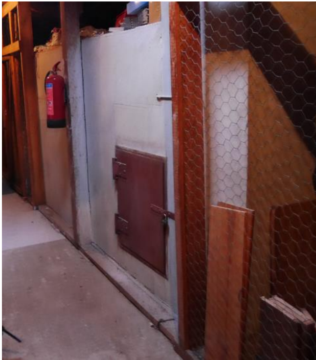
Kuva 7. Vanha lämmitysjärjestelmän paisuntasäiliön suojahuone
