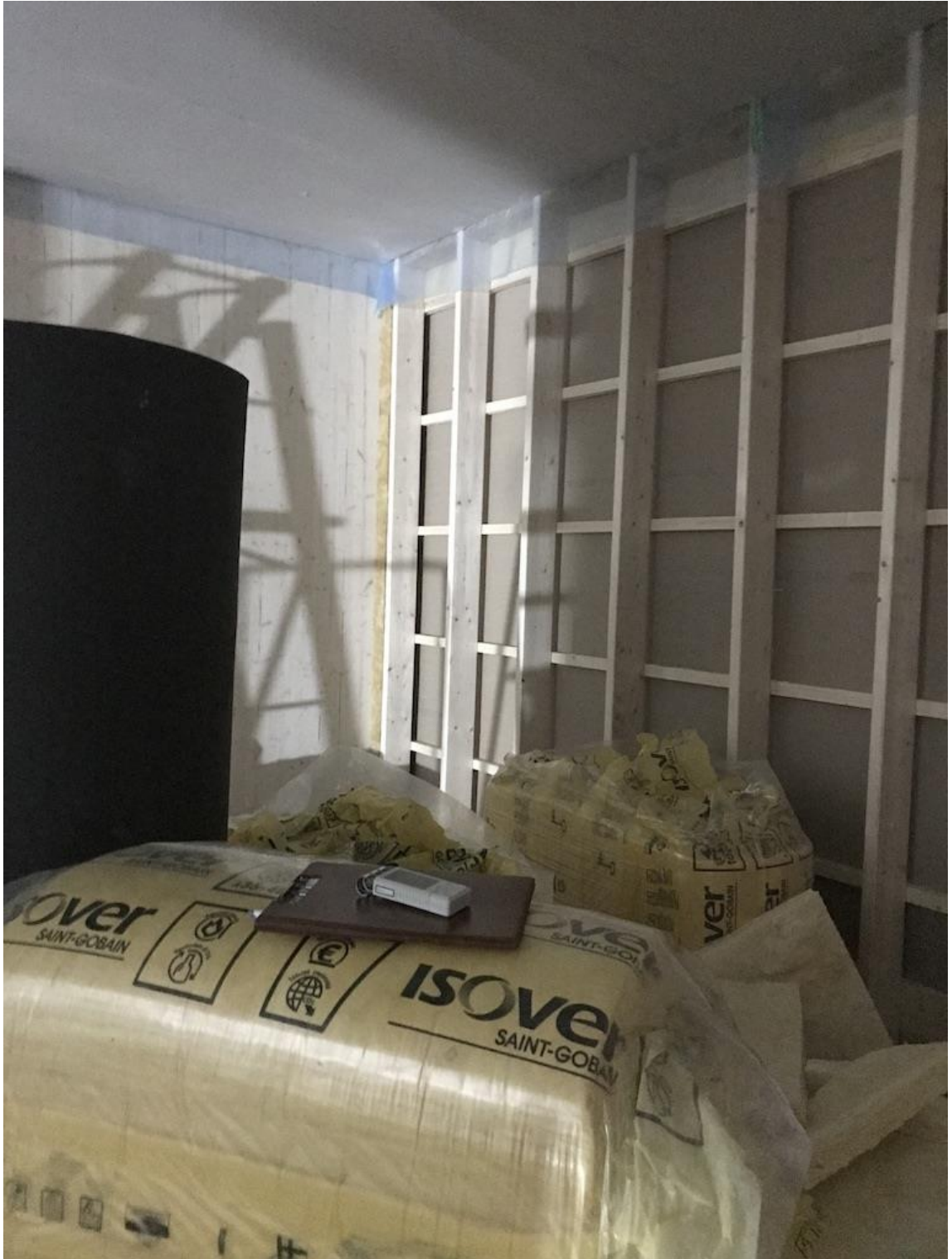
Kuva 12. Hukanhaudan päiväkodin kastunut rankarakenteinen seinä, villat purettu seinästä ja kuivatus käynnissä.
