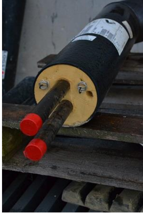
Figure 15. Twin pipes in Seitenstetten
