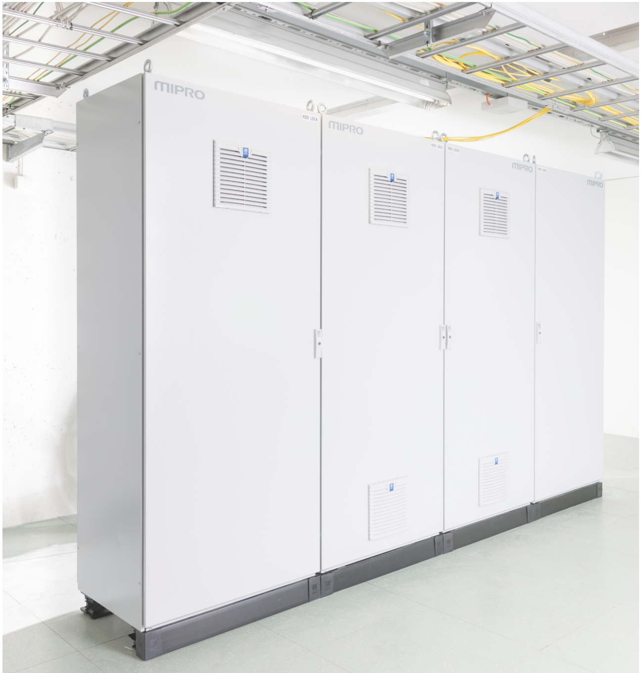
Kuva 3 Mipron automatiokeskus Länsimetron laitetilassa, Koivukylässä
