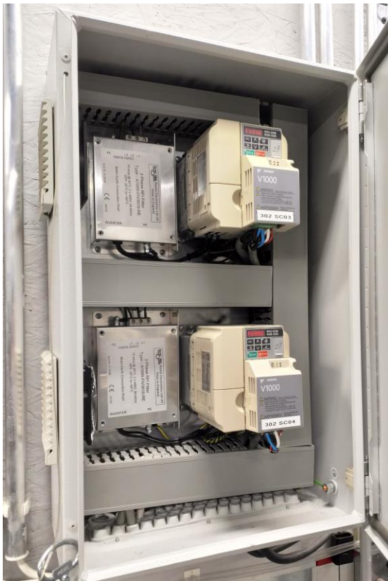
KUVA 4. IV-kojeiden puhaltimia ohjaavien taajuusmuuttajien kotelointi (Hautaniemi 2018)
