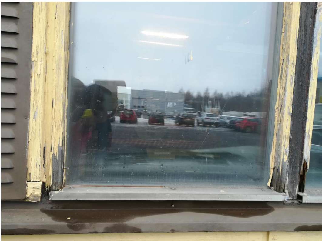
Kuva 22. Vanhan osan puiset ikkunakarmit ovat jo lahonneet.
