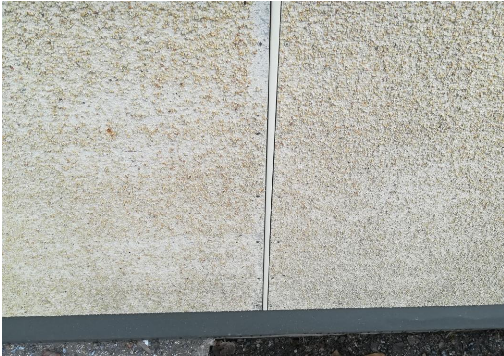
Kuva 17. Karaattijulkisivut ovat kuluneet alaosistaan.
