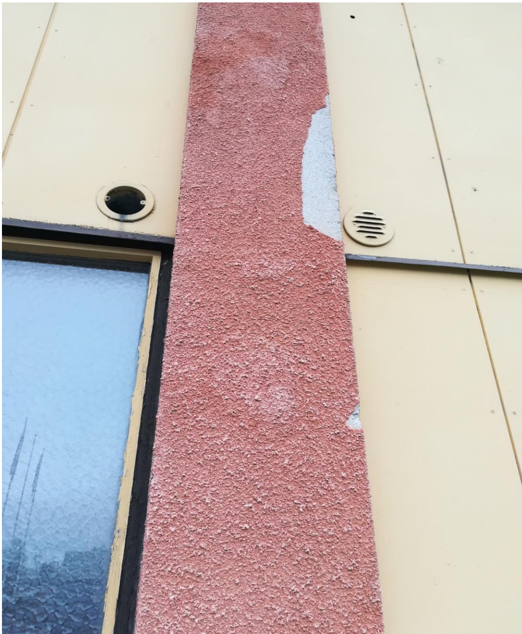
Kuva 14. Havainnekuva rappauksen irtoamisesta.
