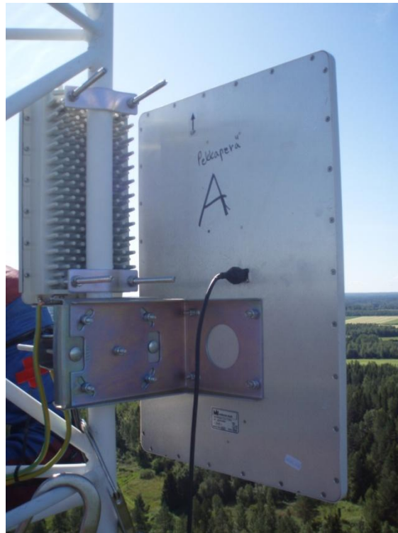
KUVA 5. Antenni ja radiolähetin asennettuina Pekkaperän mastoon kiinnikkeillä. (Salmela 2009)
