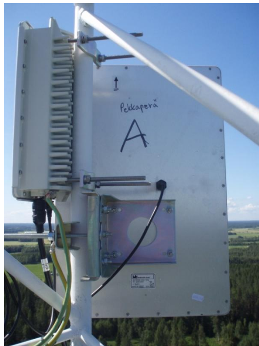
KUVA 12. Pekkerän A-solun antenni, sekä radio-osa asennettuna maston paarteeseen. (Salmela 2009)
