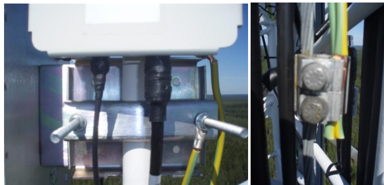
KUVA 13. Kuvassa näkyvät maadoitukset. Radio-osasta ja antennista on vedetty maakaapelit maston päämaahan. (Salmela 2009)
