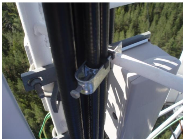
KUVA 11. 2 kpl ½”-50 RFA -kaapeli KL18/2 kiinnikkeellä asennettuna kaapeliarinaan (Salmela 2009)
