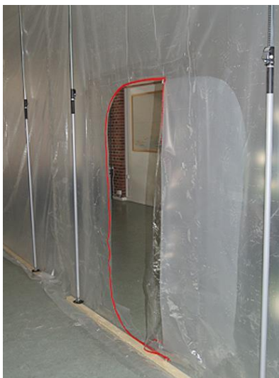
Kuva 8 Teleskooppi tuilla tehty osastointi varustettuna vetoketjuovella (Manninen 2017, 24)
