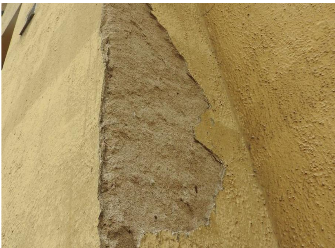
KUVA 13. Rappauksen pintakerrosta on irronnut ja täyttökerros on rapautunut (Sweco Asiantuntiapalvelut Oy 2018a)
