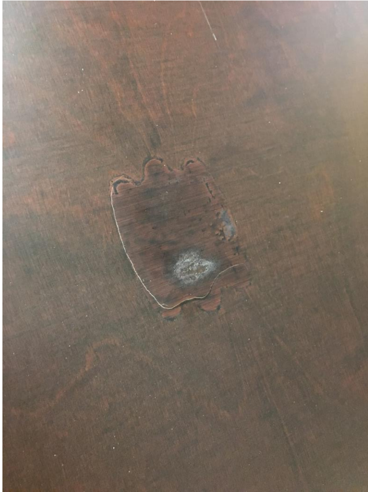
KUVA 7. Pinnoitus hajonnut paikan kohdalta
