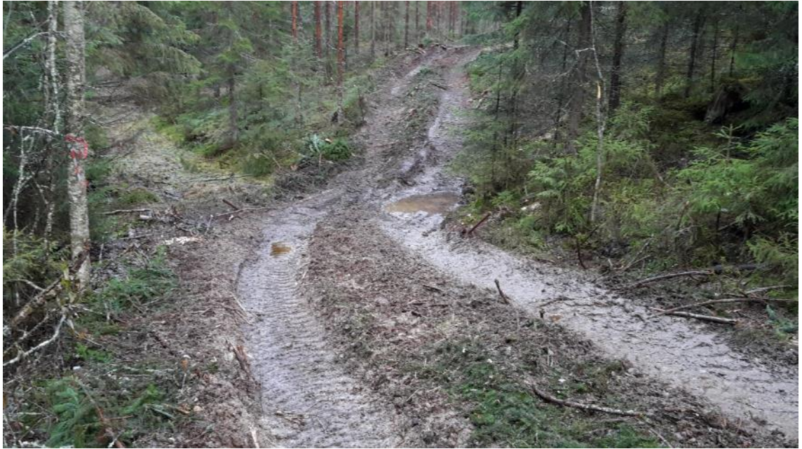
KUVA 3. Pääura heikosti kantavalla kohdalla ja havutuksesta huolimatta se ei ole kestänyt kuormitusta
