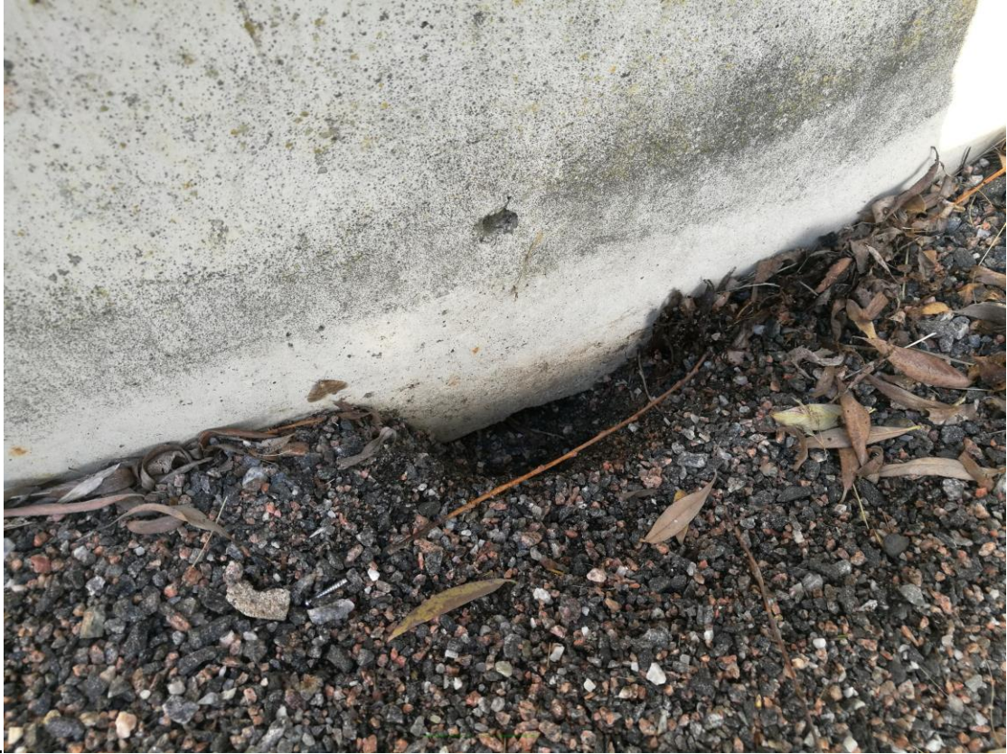
Kuva 3. Maan vajoamista sokkelilinjalla.
