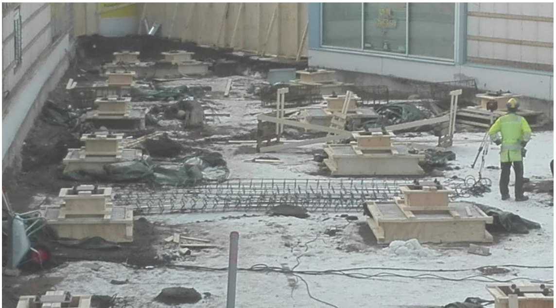
Kuva 6 M.Purolainen 2017 Kahden rakennuksen väliin tuleva laajennusosa. Anturatyöt käynnissä. Tulevat rakenteet on sovitettava olemassa olevien rakenteiden linjoihin ja korkoihin.
