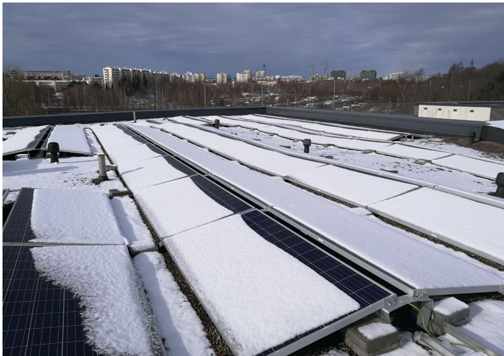
Figur 1. Solpaneler på Arcadahusets tak.
