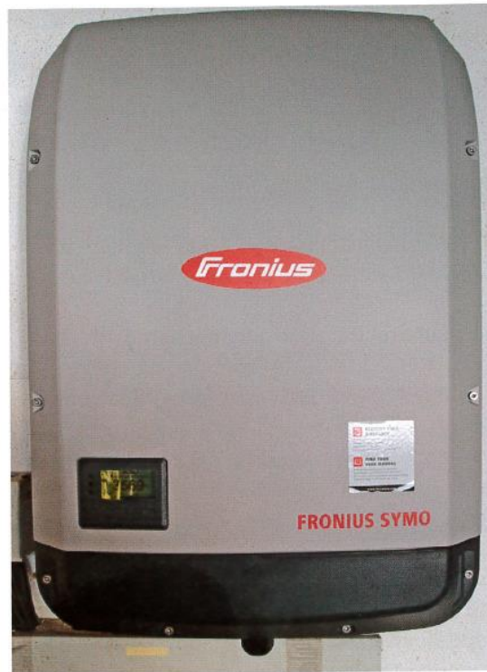
Figur 9. En inverter som är kopplad till elnätet. /4/
