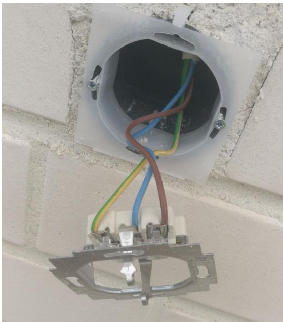
Kuva 10. Rivitalotyömaan virheellisesti kytketty ulkopistorasia.
