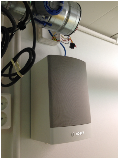
Kuva 3. Pinta-asennuskaiutin seinälle asennettuna, yläreunassa paikka linjavalvontakortille, Tjukanov Tommi 2016.
