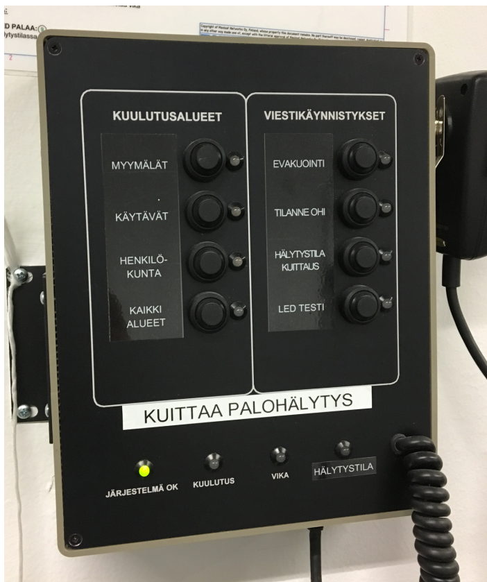
Kuva 4. Hätäkuulutuskoje eli niin sanottu palokunnankuulutuskoje seinäasennettuna kauppakeskuksen hyökkäysreitille, Tjukanov Tommi 2016.
