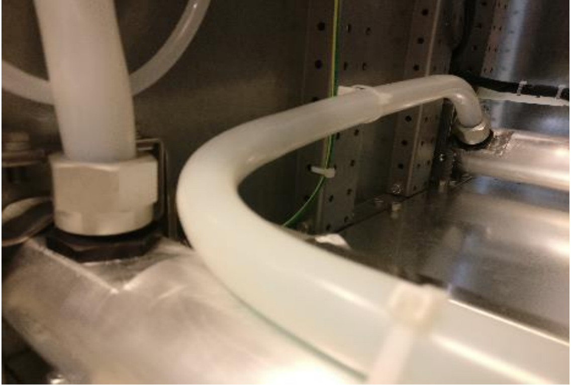
Kuva 2 Kaksi pääputkea ja niistä haarautuvat liitokset.
