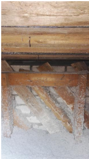
Kuva 1. Välipohja. Ennen urakkaa tutkin ja totesin välitilan olevan hyvin tuulettuva, vesitiivis ja toimiva ympäristöministeriön 7§ asetuksen mukaisesti. Seinän ja vesikaton liitos on myös teknisesti toimiva eikä vaurioitunut. (Ympäristöministeriön asetus rakennusten kosteusteknisestä toimivuudesta 7 §)
