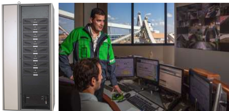
KUVA 3. DCS-järjestelmäkaappi ja valvomo (Valmet mediapankki 2018)
