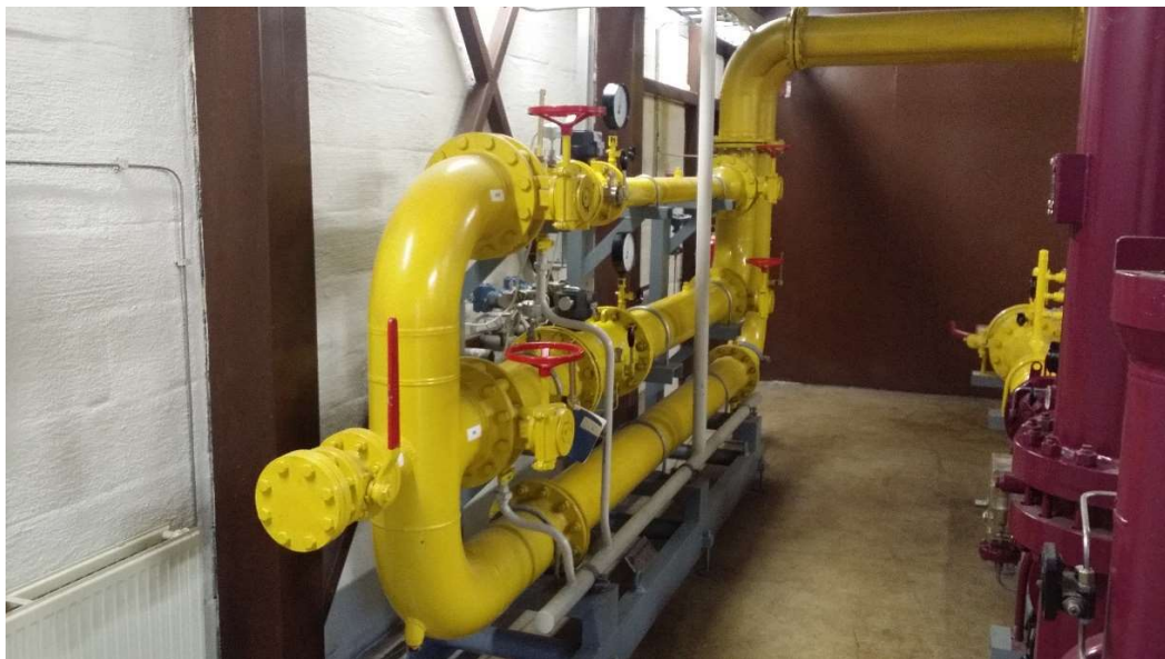
Kuva 7 Savelan PV-aseman liitântälaippa
