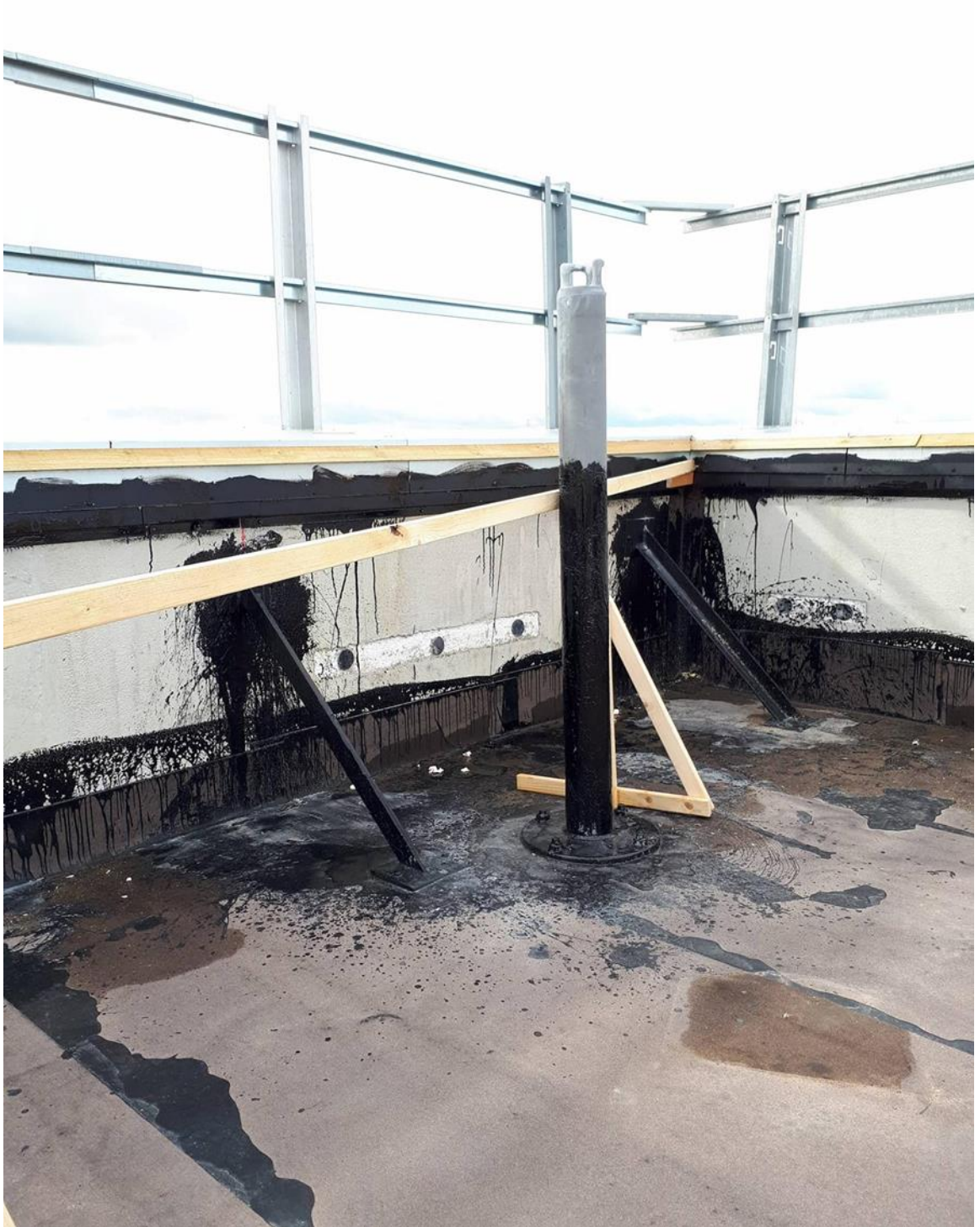
Kuva 16. Neilikkatie 8 työmaa. Vesikatto C-osa ennen valua. Kaatorimoista näkyy pavun ja betoni- nlaatan korko.
