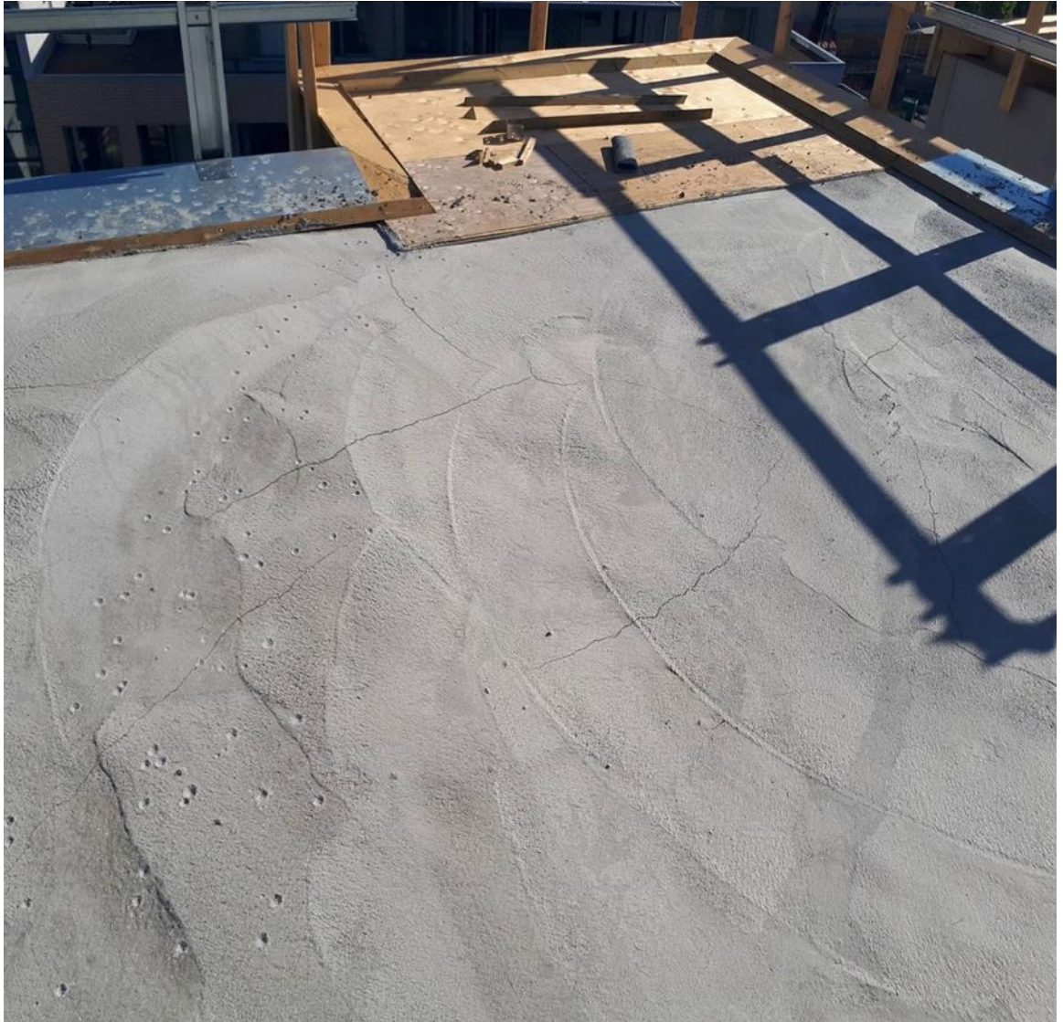
Kuva 18. Neilikkatie 8 työmaa. Valun jälkeen asennetaan kaksi kerrosta huopaa reunoille asti. Riprap-räystäään vieressä oleva puu jätetään paikoilleen, että huopa saadaan nostettua räystäään päälle.
