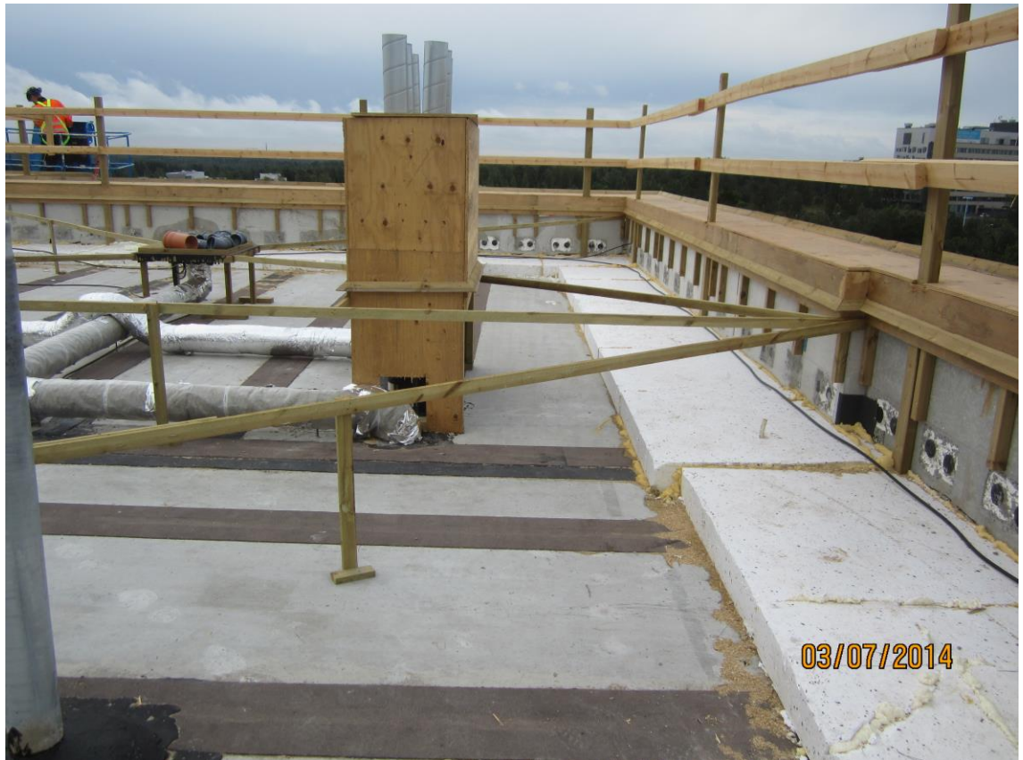
Kuva 21. Nihtitorpankuja 3 työmaa. Kaatorimat ulkoseinän kohdalta. Kuvassa näkyy turvakaiteet, jotka aiheuttavat jälkikorjauksia. Ulkoseinän linjaan asennettiin lisäeristys, koska leca-soraa käytettiin normaalia vähemmän.
