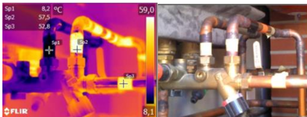
Kuva 20. Lämpimän käyttöveden syöttösekoitusventtiili [4].
