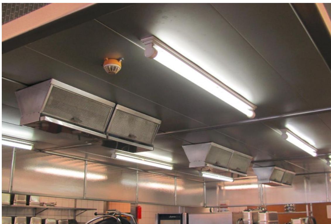
Kuva 14. Keittiön vanha kohdepoisto.
