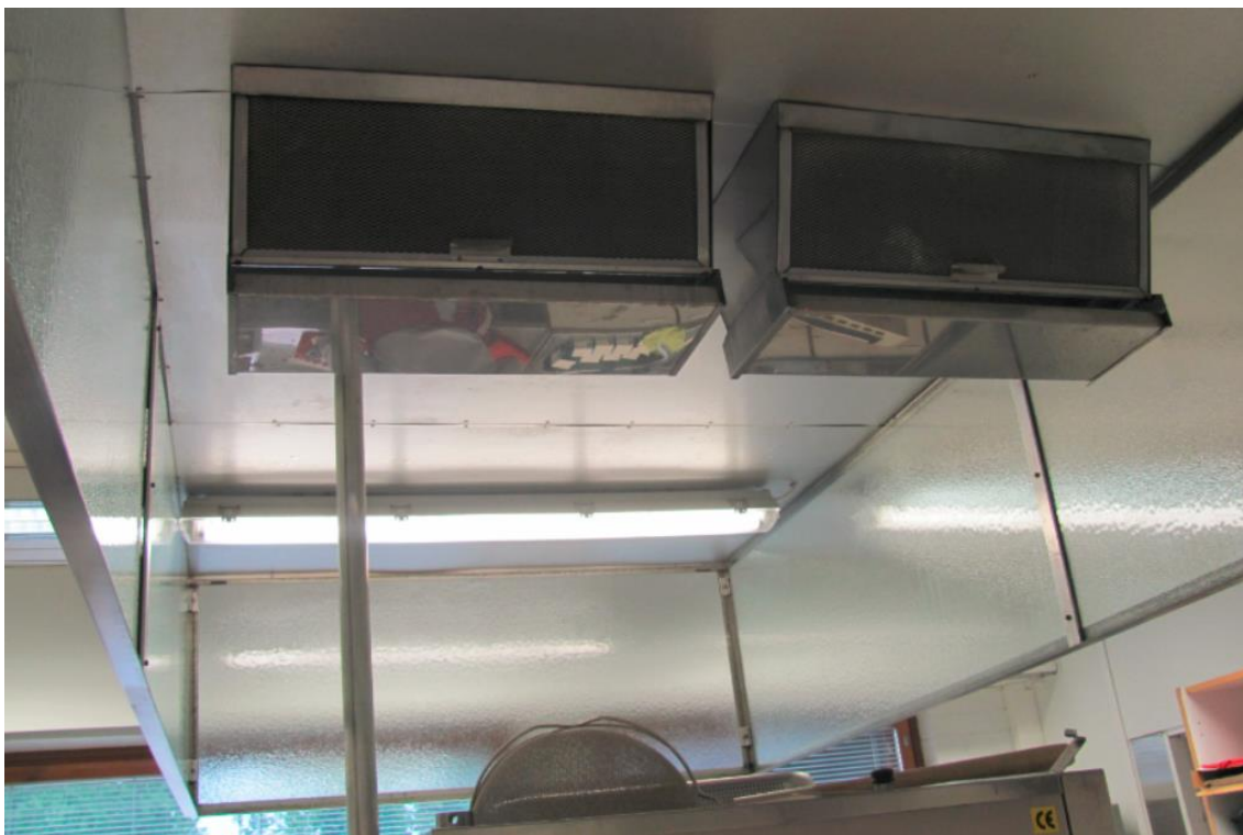
Kuva 17. Keittiön vanha kohdepoisto.
