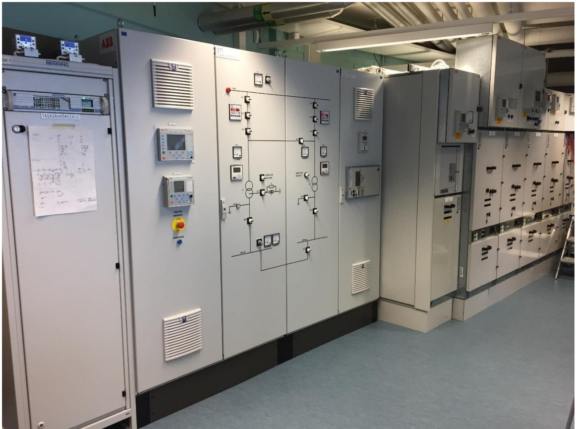
Kuva 2. Demokojeisto 110 kV / 10 kV
