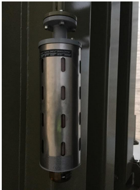
Kuva 13. Pyhäkosken vesivoimalaitoksen päämuuntajan kosteudenpoistopatruuna
